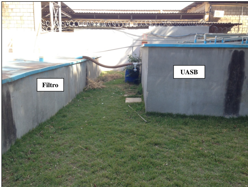
Figura 10. Tratamento secundário (reator UASB e filtro anaeróbio).
