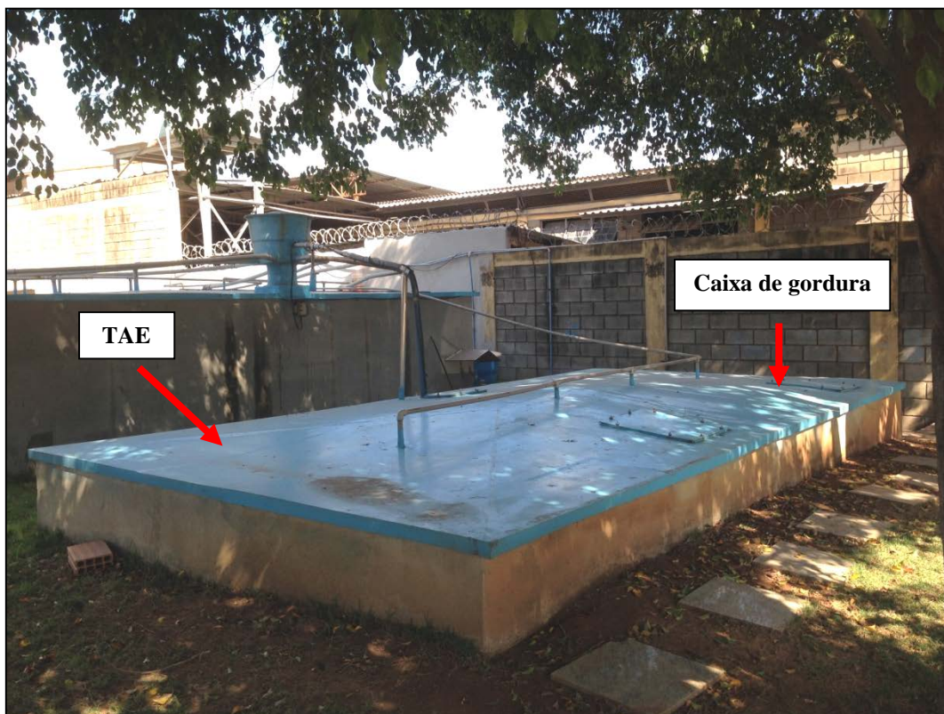
Figura 9. Caixa de gordura e tanque de equalização e acidificação.
