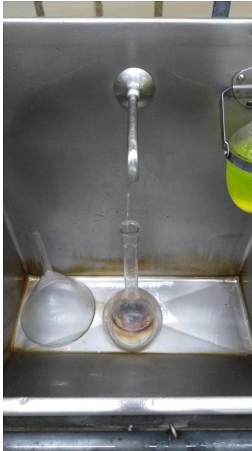
Figura 4: Mensuração do vazamento apresentado por torneira de lavagem de mãos na sala de abate.
