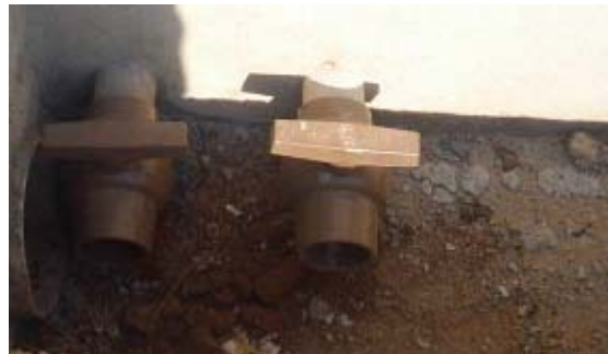
Figura 8. Tubulação de descarte do lodo
