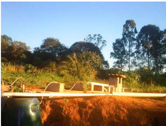
Figura 10. Vista do sistema de captação e tratamento do gás
