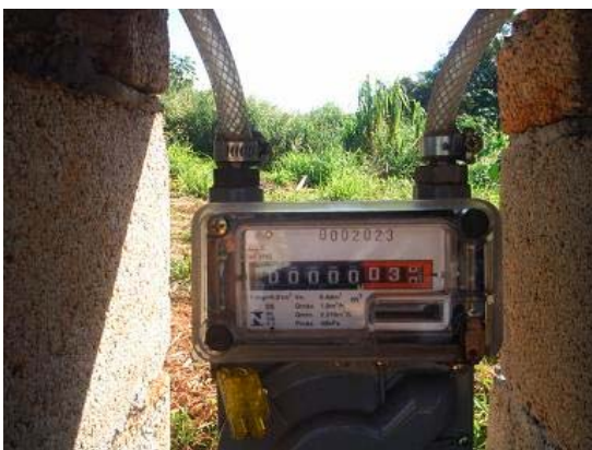
Figura 11. Medidor de gás
