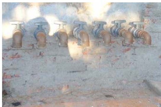
Figura 9. Tubulações de amostragem de lodo
