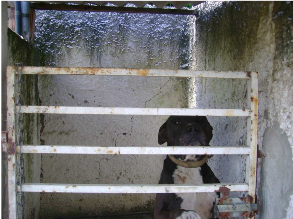
Figura 8. Residência 8. Muro chapiscado com orifícios e rachaduras.
