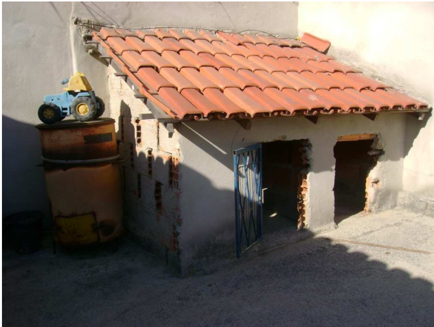
Figura 2. Residência 1. Casinha sem reboco nas paredes.
