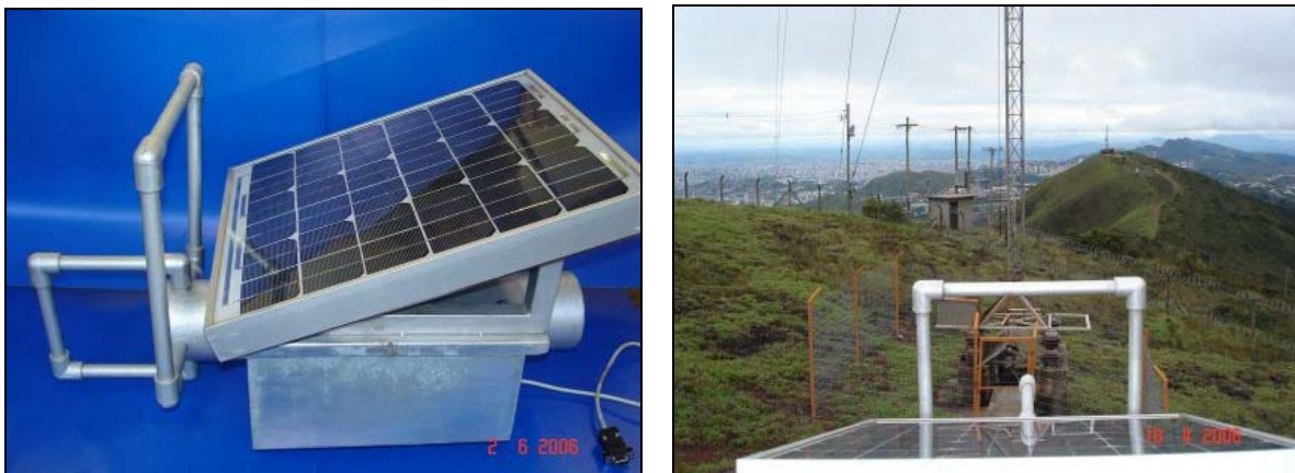
Fig. 8.11: (a) Versão atual do dispositivo (b) Foto do dispositivo instalado próximo a torre da Estação Morro do Cachimbo
