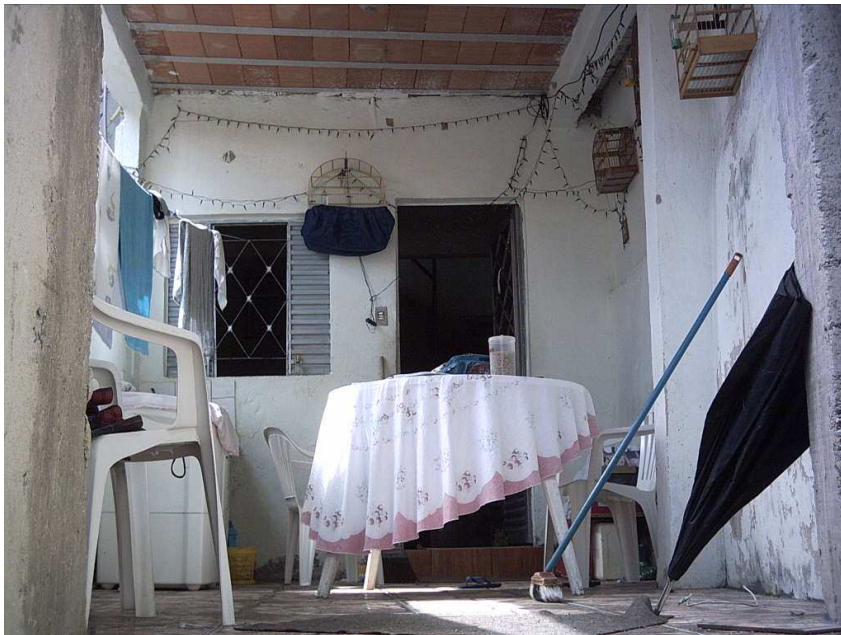
Figura 1 C – Caso 1, 2006: Entrada da casa, com estrutura de concreto armado e laje pré-moldada aparente. Na parede à direita aparecem infiltrações. A altura excessiva da verga da janela compromete ventilação e iluminação naturais.
