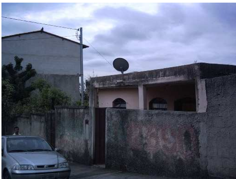
Figura 6 E – Caso 6, 2008: vista frontal da casa, cuja platibanda devido à inexistência de pingadeira, apresenta pintura bastante danificada.
