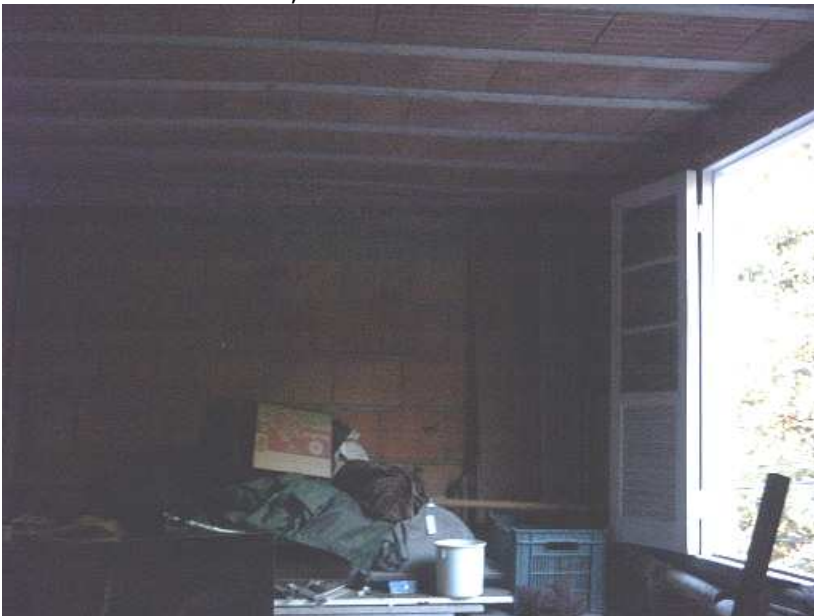
Figura 3 M – Caso 3, 2008, Kitchenettes: permanecem inacabadas.
