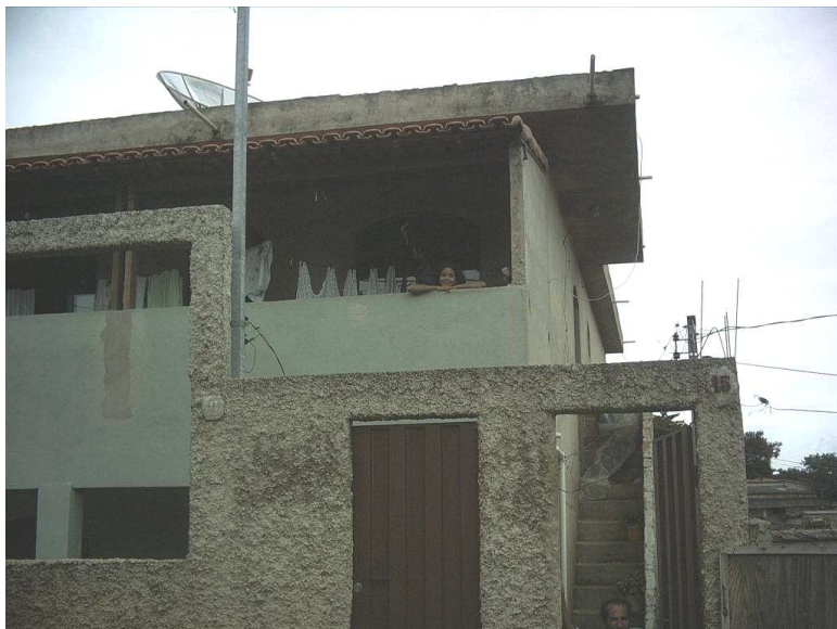
Figura 5 B – Caso 5- 2006: fachada frontal do imóvel, que possui cobertura em laje maciça de concreto com beiral mais generoso sobre a escada de acesso e varanda frontal com cobertura em telhado cerâmico
