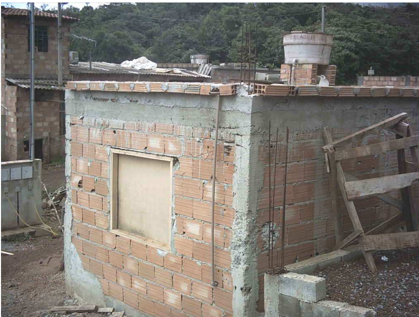
Figura 2 D – Caso 2, 2006, vista lateral. A tubulação de água é aparente e externa. A verga da janela, muito alta, foi feita com blocos comuns, sendo suportada pela própria esquadria e por ferros nas juntas da alvenaria. Não há contraverga. Há falhas no preenchimento do pilar de concreto e vergalhões de aço expostos.
