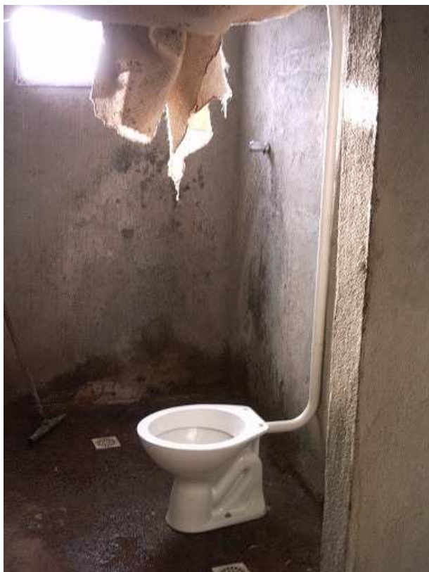
Figura 11 E – Caso 11: 2008, banheiro, no qual a falta de revestimentos impermeáveis está comprometendo o reboco.
