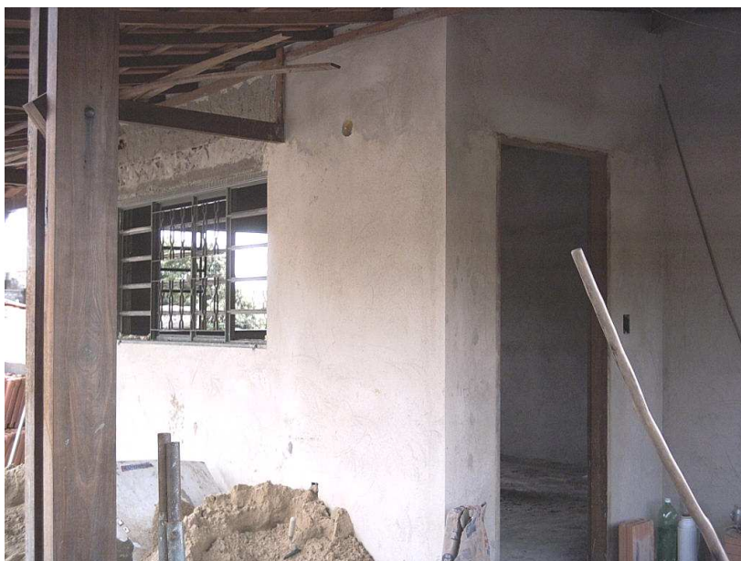
Figura 4 D – Caso 4, 2006, entrada para a sala. Observar altura excessiva da verga, em função das dimensões das esquadrias disponíveis no mercado que forçam a um peitoril alto ou a uma verga excessiva.
