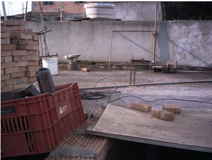
Figura 2 J – Caso 2, 2008, terraço onde se pretende construir um 2º pavimento, a partir dos vergalhões de espera. A tubulação hidráulica corre exposta sobre a laje.
