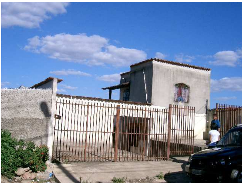
Figura 12 C- Caso 12: 2008, vista do imóvel, onde se pode observar a varanda superior e tubulação de descida pluvial aparente.
