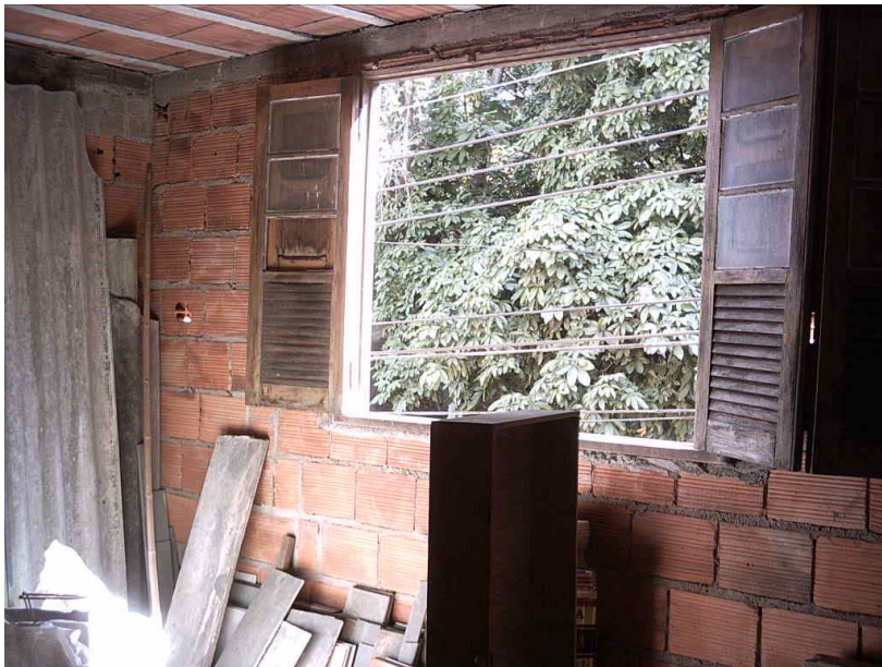
Figura 3 E – Caso 3, 2006, uma das kitchenettes acrescidas. A janela adquirida é proveniente de material de demolição. Não foi executada contra verga e a esquadria foi instalada junto à viga de amarração, tendo sido executado enchimento em blocos cerâmicos entre elas.
