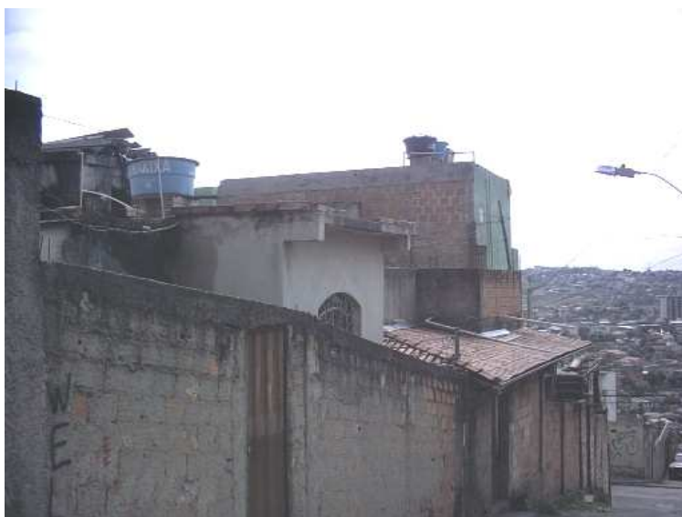
Figura 7 H – Caso 7: 2008, vista frontal, onde se pode observar a parte acrescida e o pequeno beiral que foi executado, protegendo a janela do quarto. Observar precariedade das instalações de água e presença de infiltração na alvenaria.
