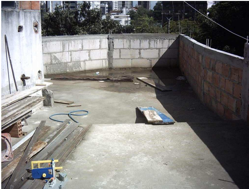
Figura 3 G – Caso 3, 2006, terraço do 3º pavimento, com esperas para futura ampliação, da qual parte foi executada, conforme nova visita em 2008. Verificar retenção de água em parte da laje de cobertura.
