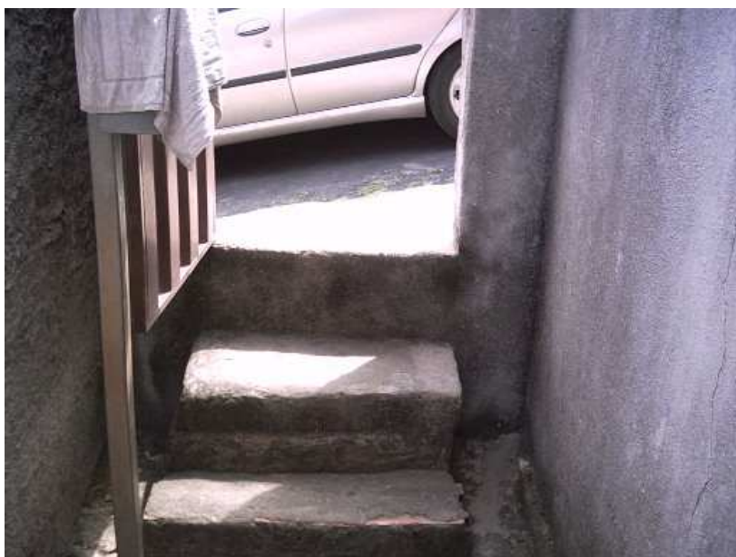
Figura 5 L – Caso 5- 2008: acesso principal, com desnível em relação à calçada e escada construída após a primeira vistoria.
