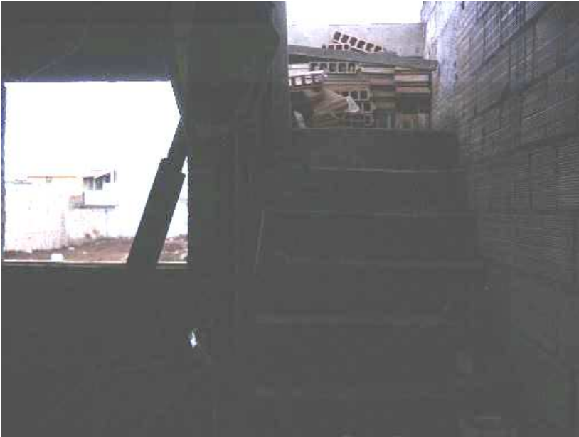
Figura 2 I – Caso 2, 2008, escada de concreto para acesso ao terraço. Como no caso 1, os espelhos são desiguais.
