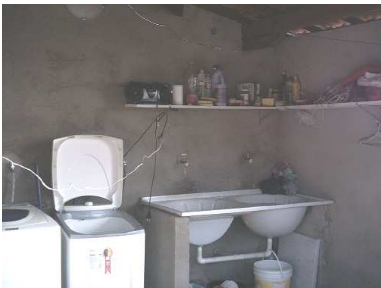
Figura 4 M – Caso 4, 2008, área de serviço, ainda sem revestimentos, na qual os pontos elétricos estão posicionados em parede diferente da qual se situam os pontos hidráulicos, obrigando o uso de extensões.
