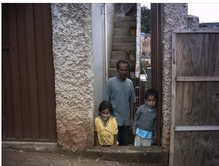
Figura 5 C – Caso 5- 2006: entrada do imóvel, com grande desnível em relação à calçada. Observar escada de acesso, cujos pisos são estreitos e espelhos apresentam alturas desiguais.
