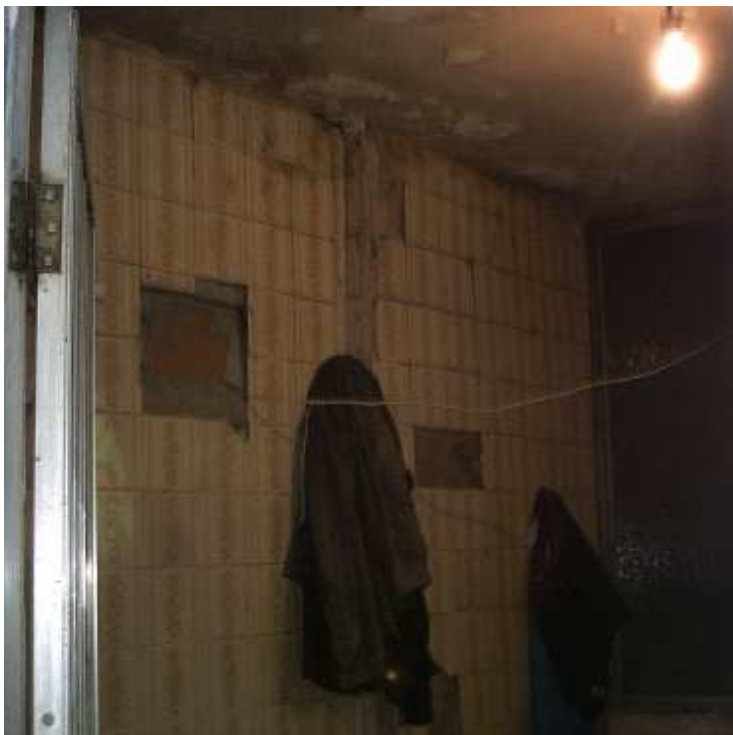
Figura 8 E – Caso 8: 2008, banheiro que não sofreu intervenções após a instalação da cobertura, onde se pode perceber revestimento e reboco do teto bastante deteriorados.
