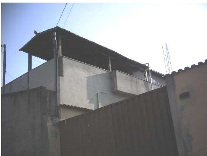
Figura 4 R – Caso 4, 2008, lateral direita do imóvel. Observar alimentação de água invadindo terreno do vizinho e reboco executado.
