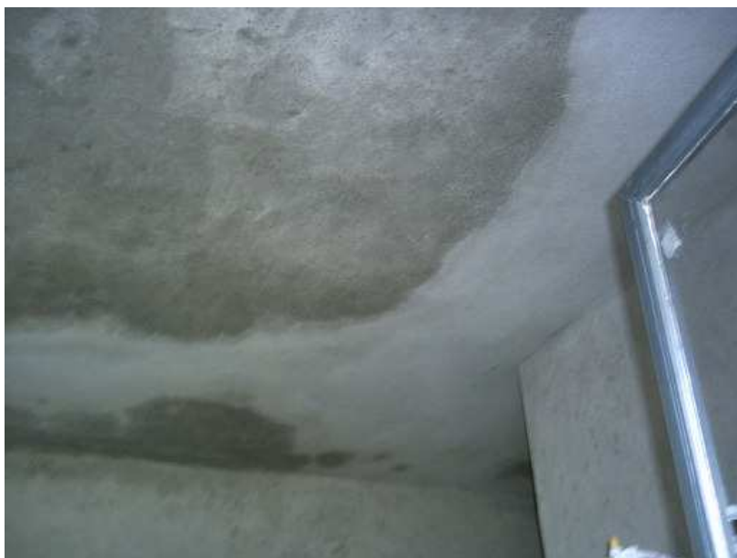
Figura 5J – Caso 5 - 2008: presença de infiltrações generalizadas na laje de cobertura não verificadas na primeira vistoria.
