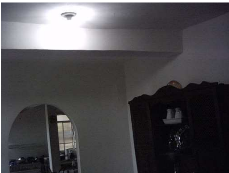
Figura 8 F– Caso 8: 2008, copa. Observar existência de viga decorrente de um dos acréscimos realizados. A laje e a viga apresentam-se desniveladas.
