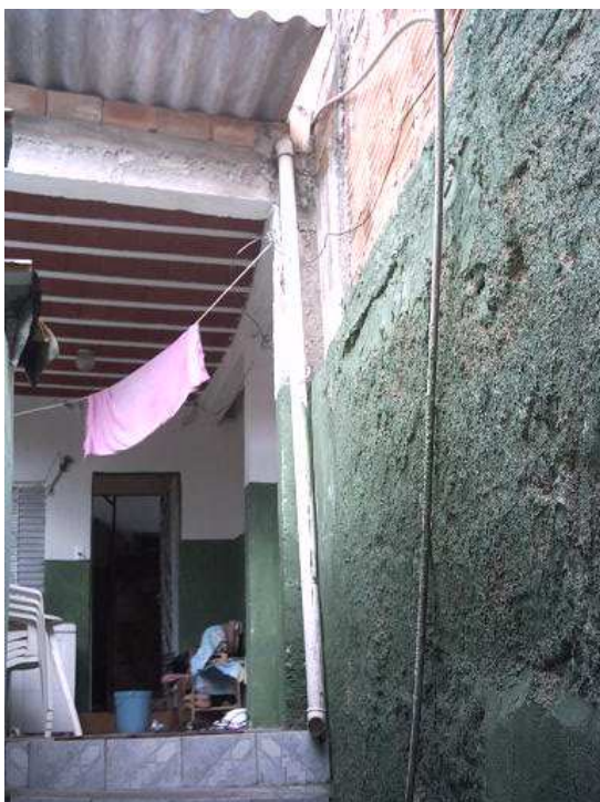
Figura 1 H – Caso 1, 2008: Entrada com novo telhado em fibrocimento e nova pintura. Observar instalações aparentes.
