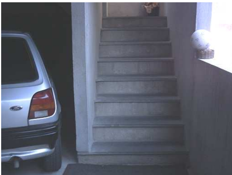
Figura 4 I – Caso 4, 2008, escada de acesso ao 2º pavimento, já acabada. Os pisos são muito estreitos e os espelhos possuem alturas variadas, o que torna o percurso bastante desconfortável.
