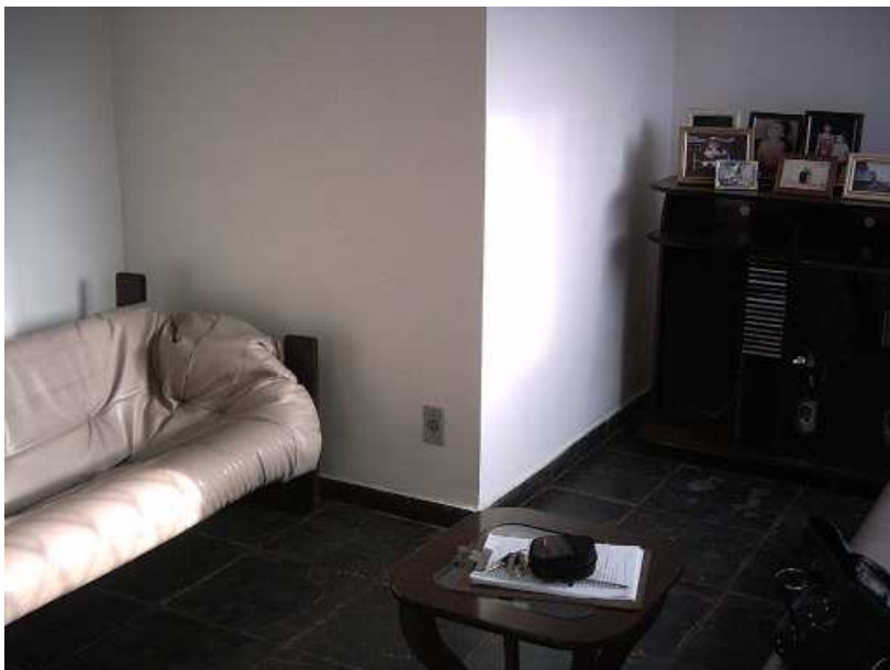
Figura 8 C – Caso 8: 2008, sala com pintura executada recentemente, após substituição do reboco que se encontrava deteriorado, face aos vazamentos da laje, corrigidos com a instalação da cobertura metálica.
