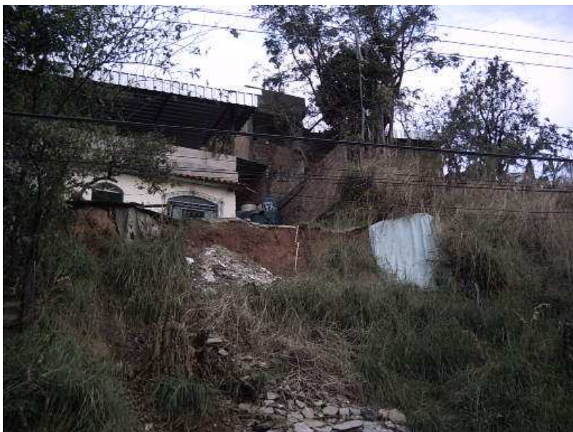
Figura 8 M- Caso 8: 2008, barranco frontal, necessitando de obras de contenção.
