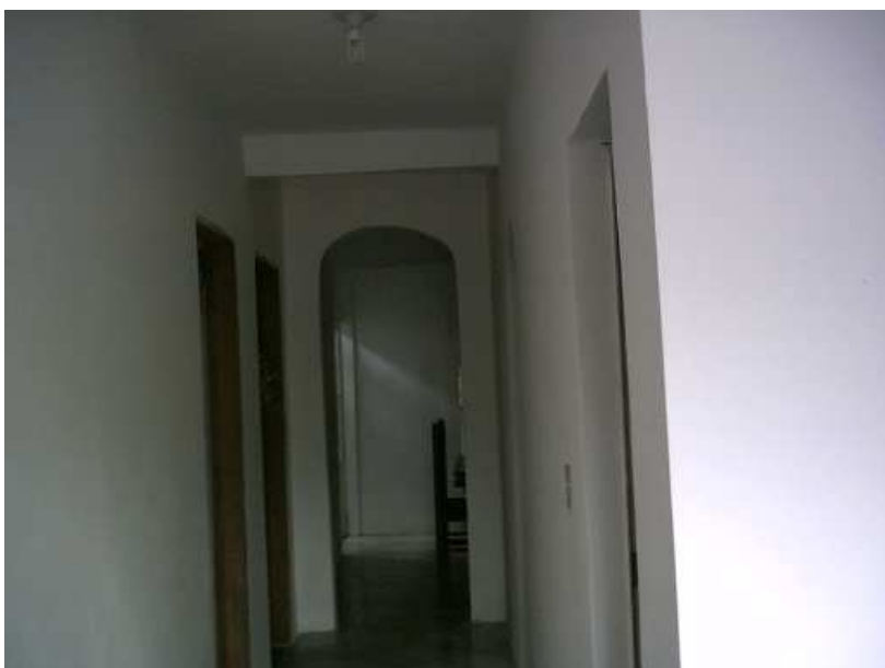
Figura 8 D – Caso 8: 2008, corredor de acesso aos quartos, banheiro e copa. Observar existência de desnivelamento na viga.
