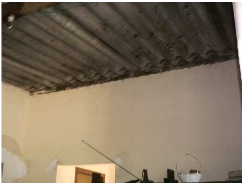
Figura 7 G – Caso 7: 2008, sala pertencente ao núcleo original com cobertura em telhas de fibrocimento sem forro. Observar correção de trincas provenientes da deficiência ou inexistência de vergas nas portas.
