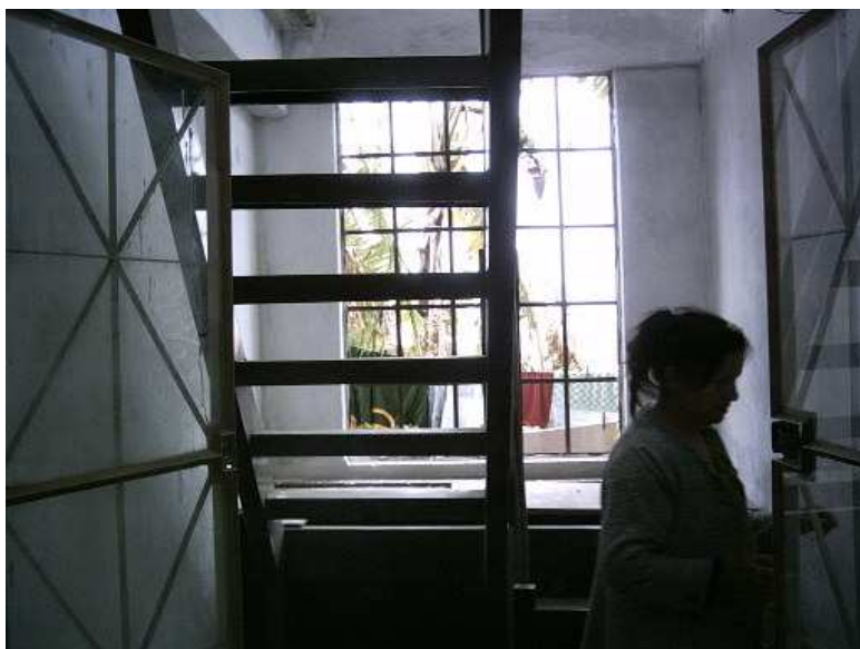
Figura 8 G– Caso 8: 2008, escada de acesso ao 2º pavimento. Os pisos são muito estreitos (15 cm) e os espelhos possuem altura superior a 20 cm.
