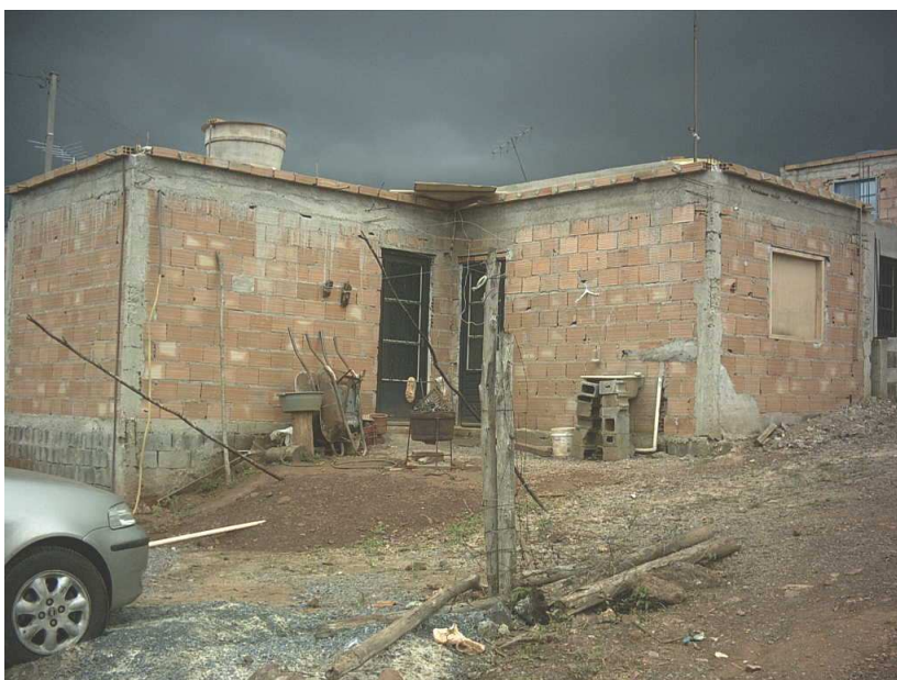
Figura 2 B – Caso 2, 2006, vista geral da esquina. A casa foi executada com fundação de blocos de concreto, estrutura de concreto e alvenaria de blocos cerâmicos, inicialmente sem a sala. Embora a cobertura seja apenas uma laje plana, maciça, houve o cuidado de criar um pequeno beiral de blocos para proteger as paredes.
