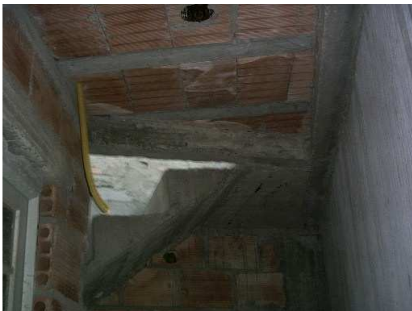
Figura 3 N – Caso 3, 2008, escada de acesso ao terraço: observar pouca espessura da estrutura da escada. Foi executada verga sobre o vão da porta de acesso a uma das kitchenettes.
