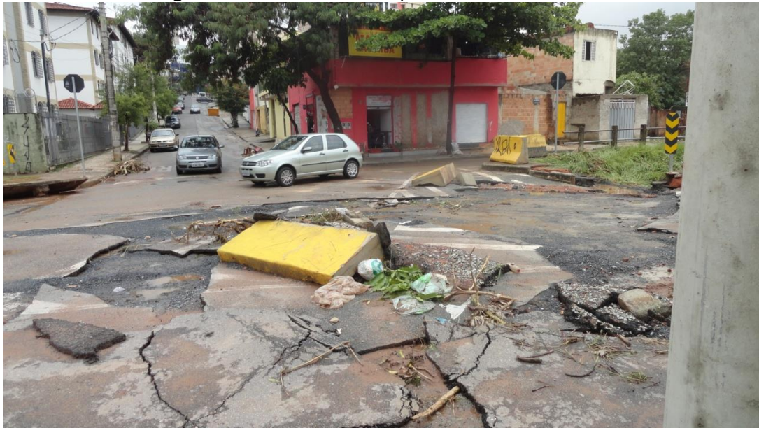
Figura 39 –Dano causado por enxurrada no local.
