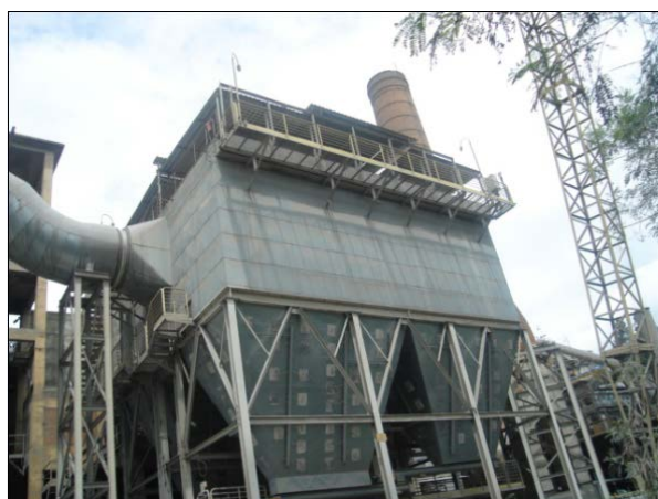
FIGURA 10: Filtro de mangas do forno Fonte: Mineração Belocal – Grupo Lhoist, 2011
