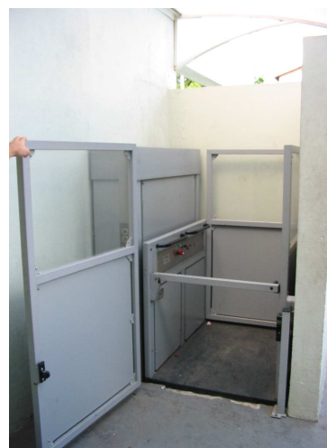
Foto 8B – Elevador para cadeirantes – detalhe.
