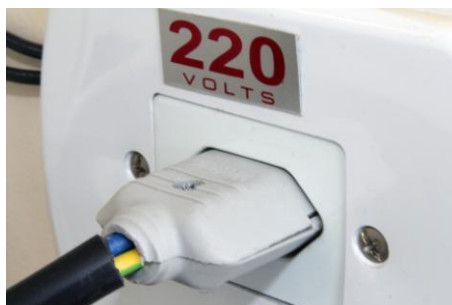
Figura 6 – Tomada com identificação de voltagem
