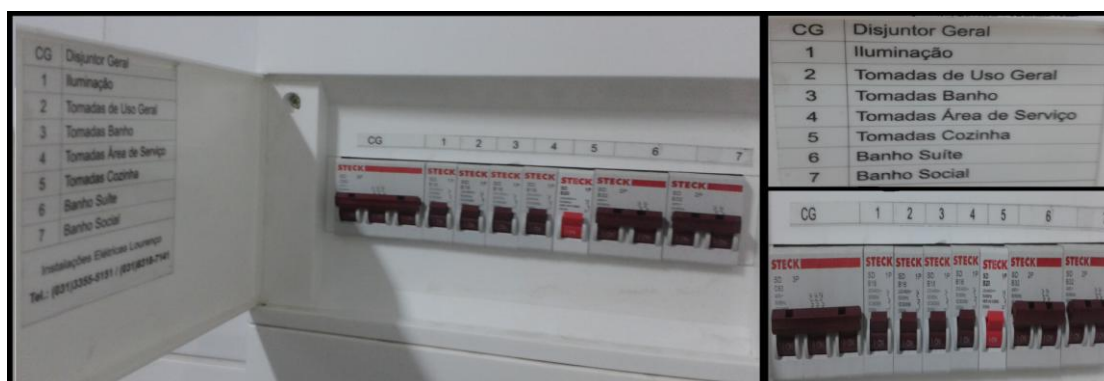
Figura 4 – Quadro de luz com identificação dos circuitos
