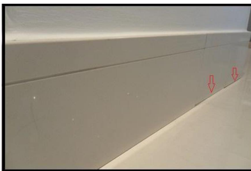
Foto 3 – Problemas no Rodapé
