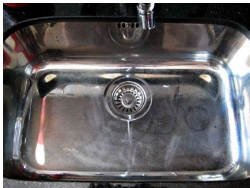
Figura 8 – Cuba metálica com riscos e manchas
