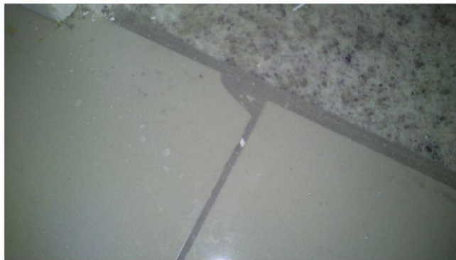
Figura 10 – Piso cerâmico com trinca
