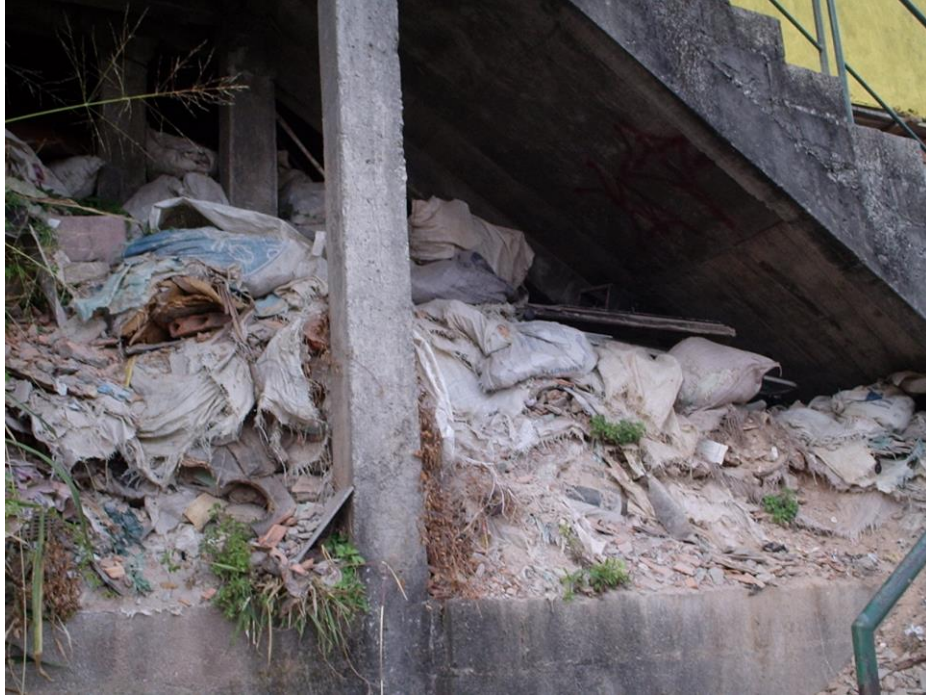
Figura 18: RCD depositado em vão de escada do Beco Lírrio (Barragem Santa Lúcia)
