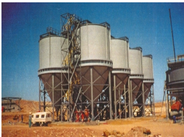
Figura 3.10: Espessador de alta capacidade Ultrasep medindo 7m de diâmetro x 10 m de altura, utilizado para minerais pesados, localizado Namakwa Sands, África do Sul (DELKOR).
