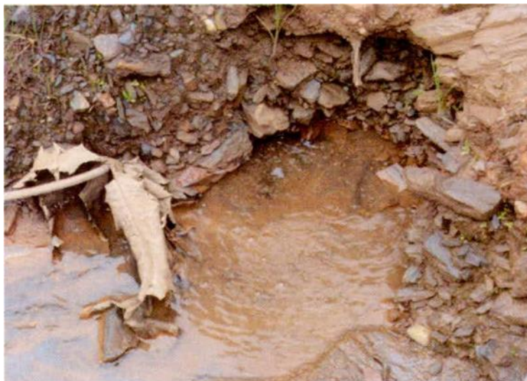
Figura 55: Surgência com pressão (artesianismo) observada no pé do talude de jusante da barragem em 27 de agosto. Fonte: Samarco/MT.
