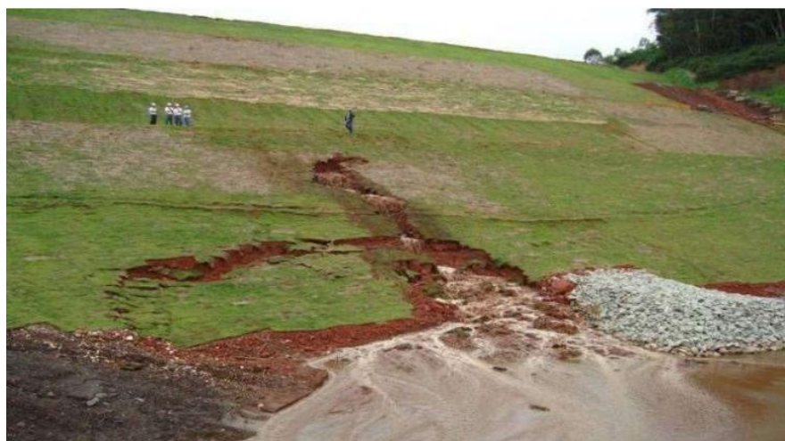
Figura 39: Incidente ocorrido em abril de 2009, que apresentou uma forte percolação com processo erosivo interno e surgência no talude, com consequente escorregamento parcial desse talude. Notar o início do lançamento de enrocamento para formar a berma de estabilização. Fonte: (Ministério Público Federal, 2016).
