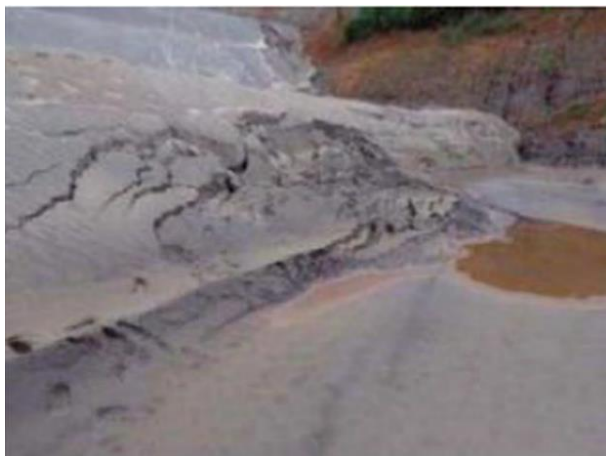
Figura 52: Surgências, trincas e deslizamento em novembro de 2013. Fonte: (Morgenstern et al., 2016).
