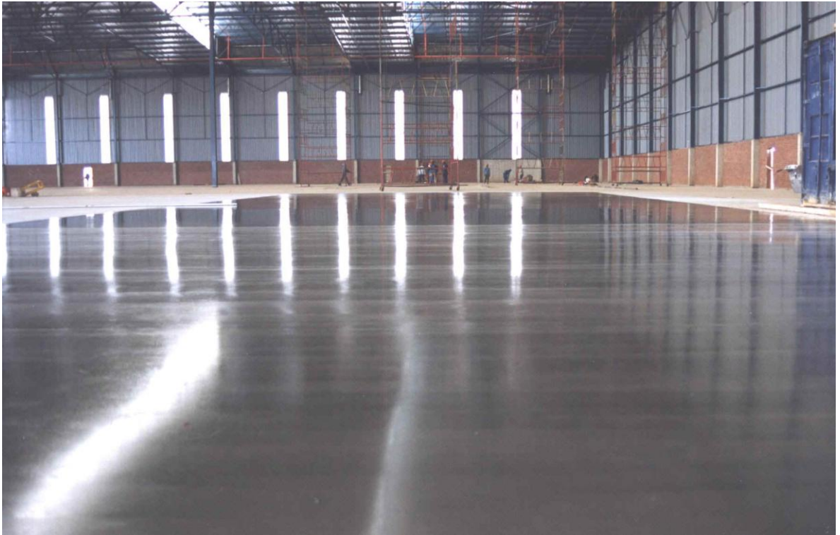
Figura 46 – Resultado final do piso industrial em concreto armado Fonte: Arquivo da ArcelorMittal
