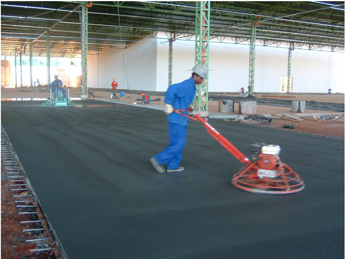
Figura 43 – Acabadora simples Fonte: Arquivo da ArcelorMittal
