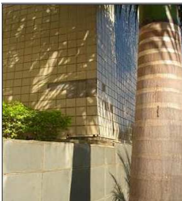
FOTO 1.9 – Outra vista da foto mostrada na figura 1.8, tomada por outro ângulo. Observar deslocamento no encontro da peça estrutural com as paredes. Fonte: IBAPE/BA
