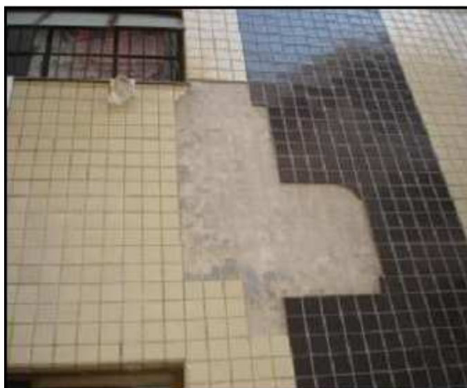
FOTO 1.10 – Vista da fachada lateral direita. Deslocamento junto ao encontro das placas de cerâmicas de tonalidades diferentes. Fonte: IBAPE/BA
