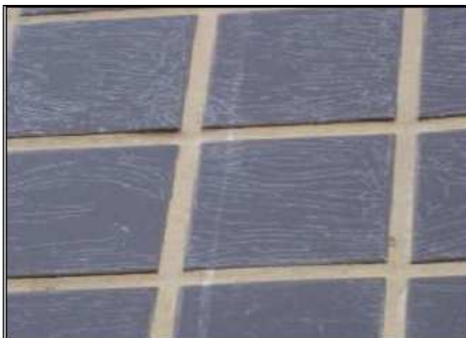
FOTO 1.15 – Vistas de peças cerâmicas na fachada. Observar gretamento, ou seja, fissuras sobre a superfície vidrada. Fonte: IBAPE/BA
