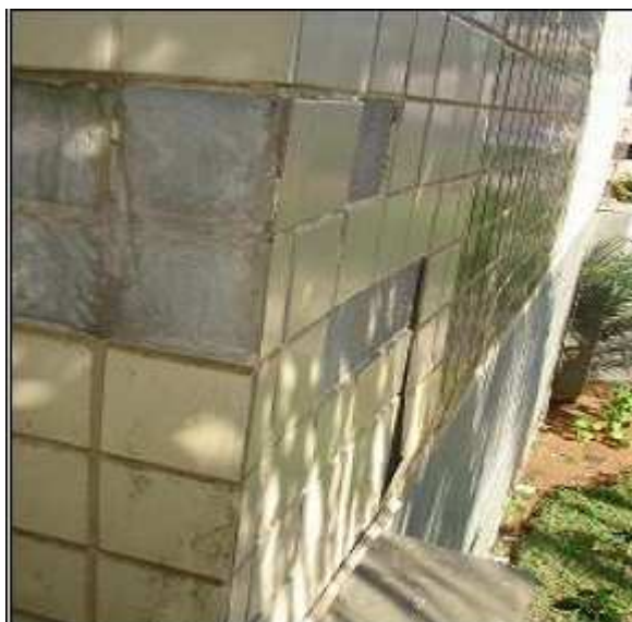
FOTO 1.8 – Vista frontal e lateral direita. Observar deslocamento no encontro da peça estrutural com as paredes. Fonte: IBAPE/BA
