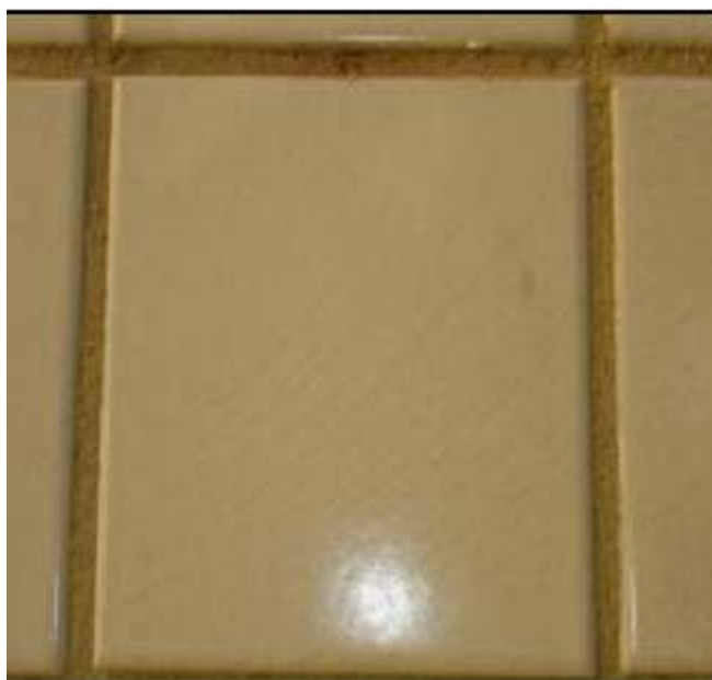
FOTO 1.12 – Vistas de peças cerâmicas na fachada. Observar gretamento, ou seja, fissuras sobre a superfície vidrada. Fonte: IBAPE/BA
