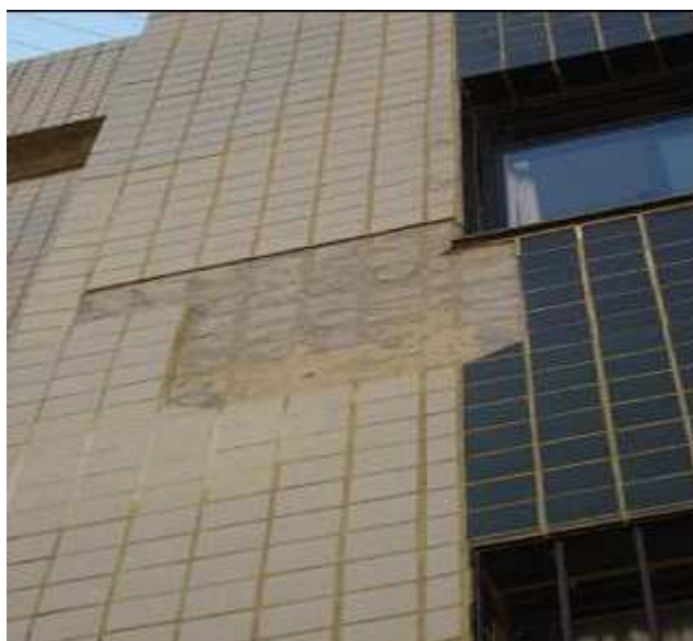
FOTO 1.13 – Vistas da fachada lateral esquerda. Deslocamento e tonalidade diferenciada entre as peças já substituídas e as originais da cerâmica bege. Fonte: IBAPE/BA
