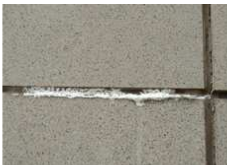
FOTO 1.2 – Eflorescência. Fonte: http://www.revistatechne.com.br/engenharia-civil/116/artigo35346-3.asp
