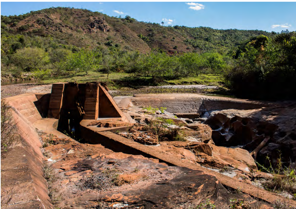
Figura 27 - Ruínas da PCH de Bicas Fonte: Repertório do autor
