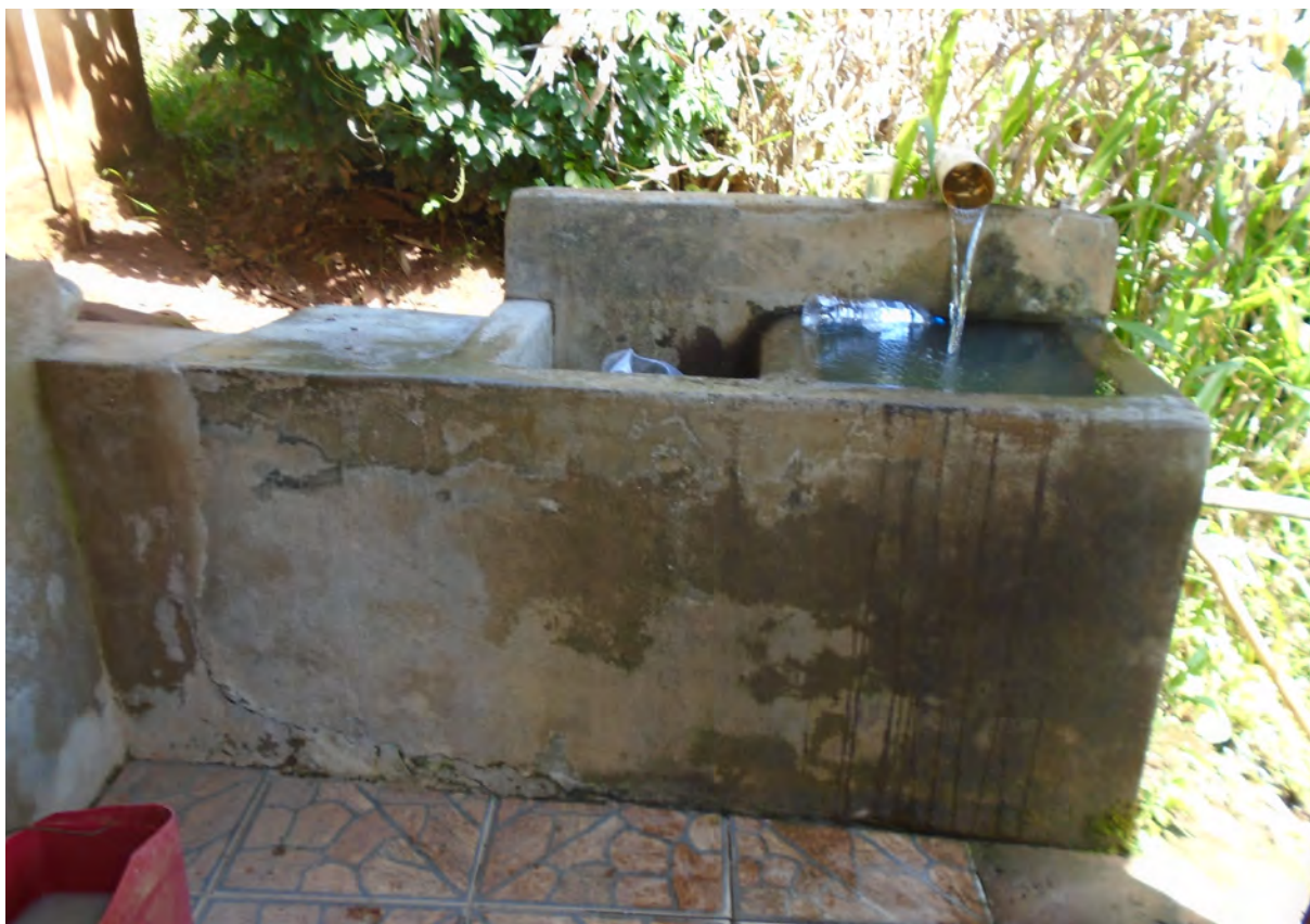
Figura 16 - Captação de água da nascente na casa de Jorge Fonte: Repertório do autor
