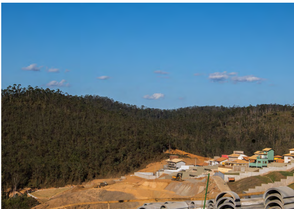
Figura 102 - Casas em construção no Reassentamento de Bento Rodrigues Fonte: Repertório do autor
