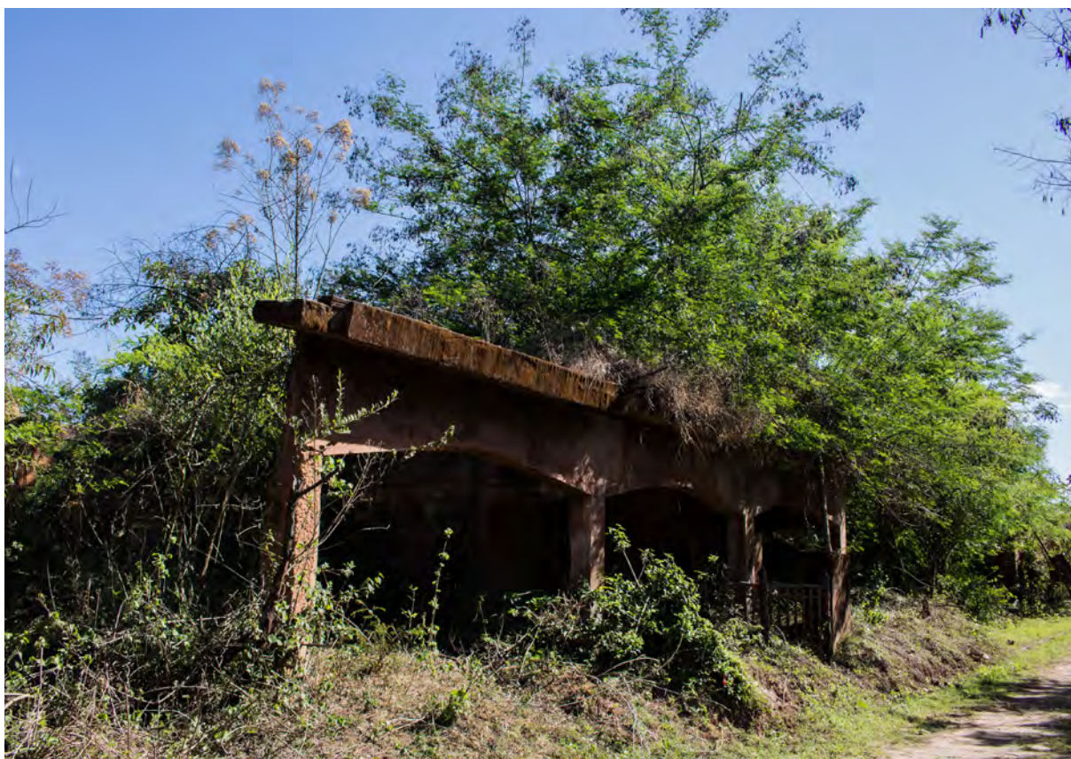
Figura 92 - Ruína de edificação habitada por vegetação de leguminosas e gramíneas Fonte: Repertório do autor
