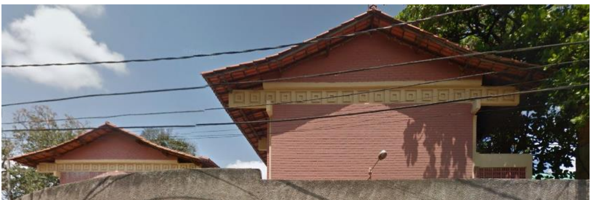
FIGURA 117 - EE Necésio Tavares no bairro Alto Vera Cruz em Belo Horizonte – Desvio do padrão - Detalhe nas vigas (Google Street View, 2016)
