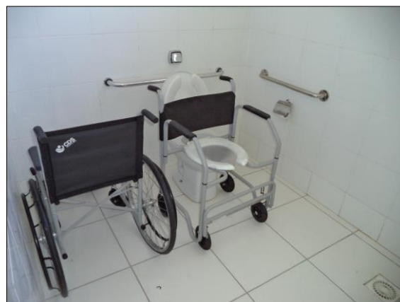
Figura 32 – Banheiro adaptado Fonte: A autora, 2018.
