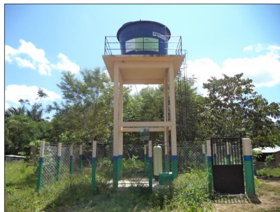
Figura 27 – Reservatório e filtro
