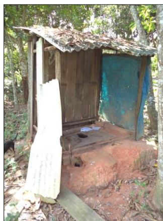
Figura 61 – “Sanitário” (B) Fonte: A autora, 2018.
