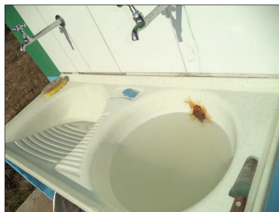
Figura 65 – Dano e entupimento no tanque Fonte: A autora, 2018.
