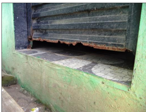
Figura 77 – Porta do banheiro com sinais de corrosão Fonte: A autora, 2018
