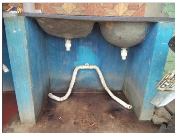
Figura 74 – Sifão danificado Fonte: A autora, 2018.
