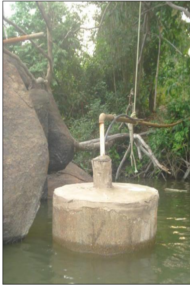
Figura 39 – Captação de água bruta do rio Xingu
