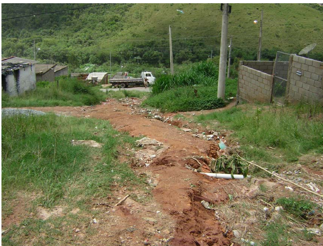
Figura 66 - Rua traçada de forma irregular, desgastadas pela ação das águas
