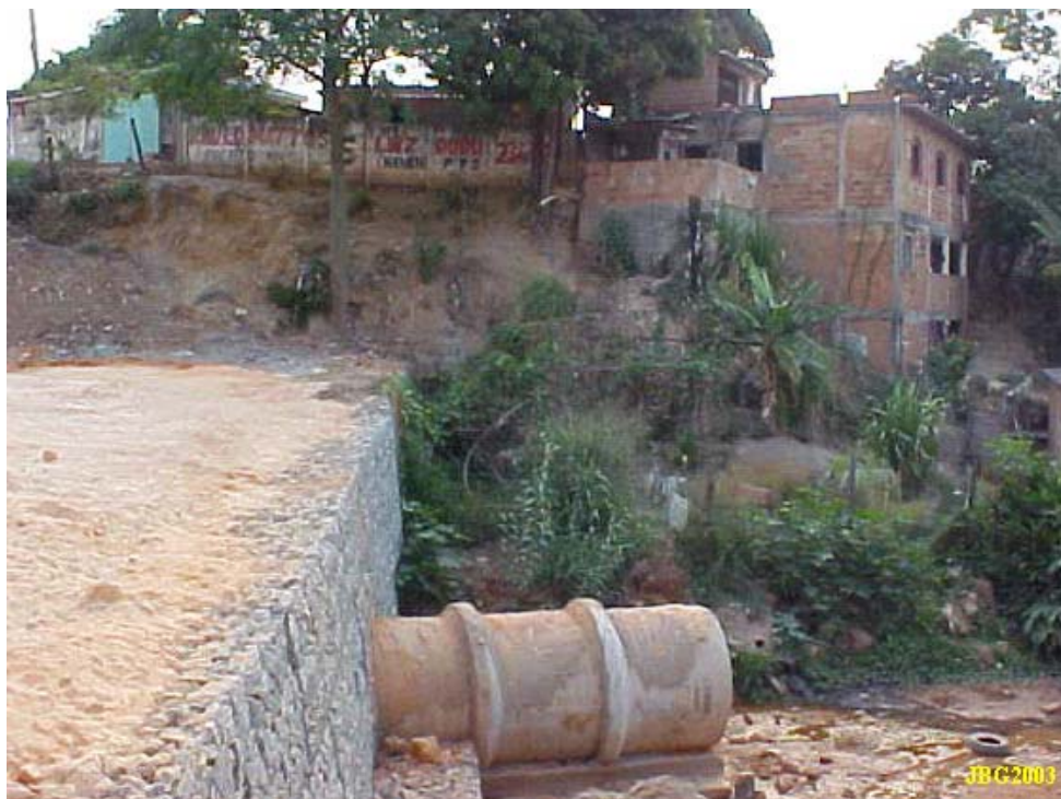
Figura 70 - Exemplo em Contagem: Prof. Edézio. Aterro dique para controle da vazão das águas pluviais em bairros de baixa renda – Processo de construção.
