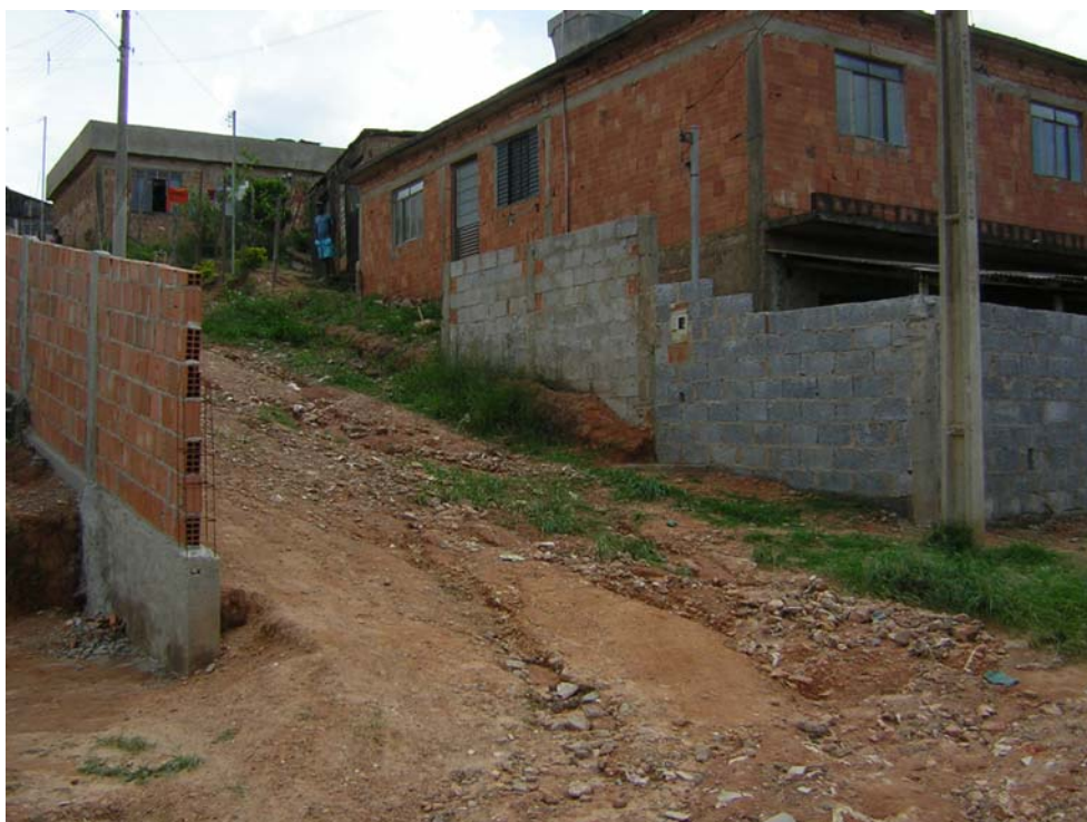
Figura 91 - Rua antes da intervenção.
