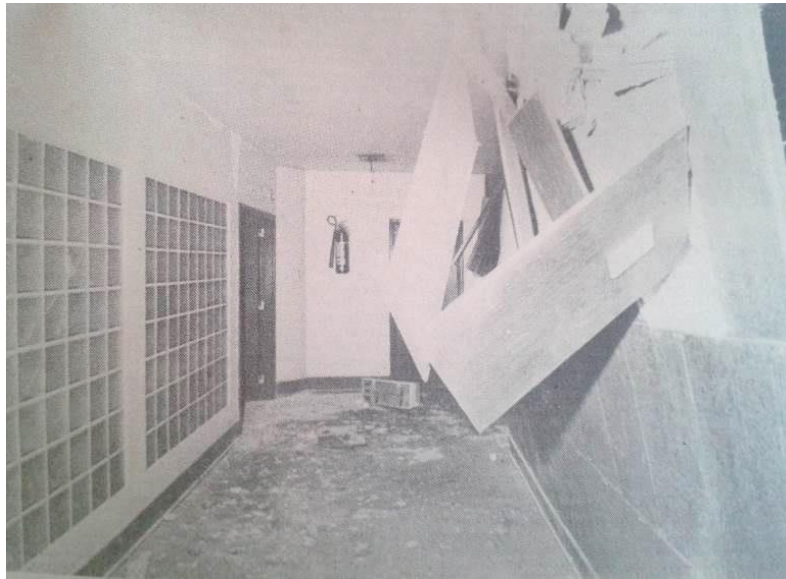
Figura 88 – Foto do sétimo pavimento, após a explosão da bomba em 1976.
