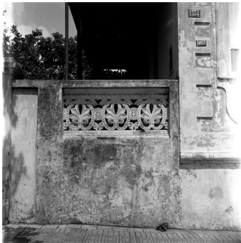
FIGURA 110: Grade de cimento na varanda de residência
