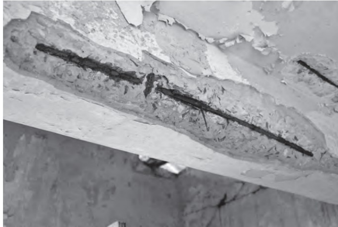
Figura 2: Estado avançado de corrosão das armaduras da face inferior de uma viga
