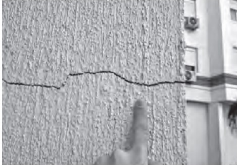
Figura 1: Fissura ou trinca observada em um sistema de vedação vertical
