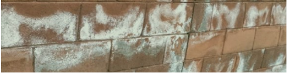
Figura 3: Aparência de tijolos cerâmicos após surgimento de eflorescência
