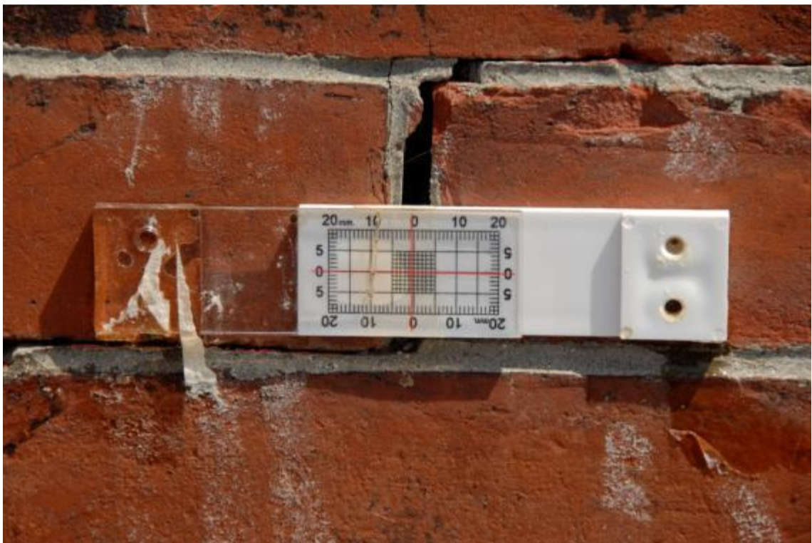
Figura 4.2.2 Extensômetro mecânico fixado em um muro de contenção
