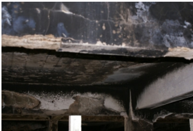
Figura 2.2.5.5 Estado de uma estrutura agredida pelo fogo
