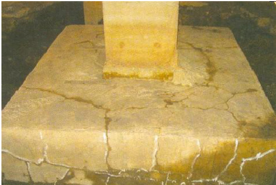
Figura 2.2.6.3 Mapeamento de fissuras em blocos de fundação devido à reação álcali-agregado.
