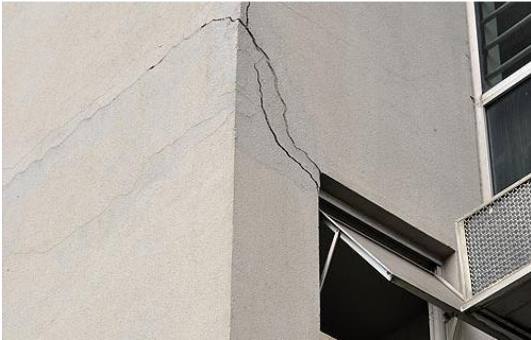
Figura 4.2.1.1 Trincas que se formaram por falta de junta de movimentação
