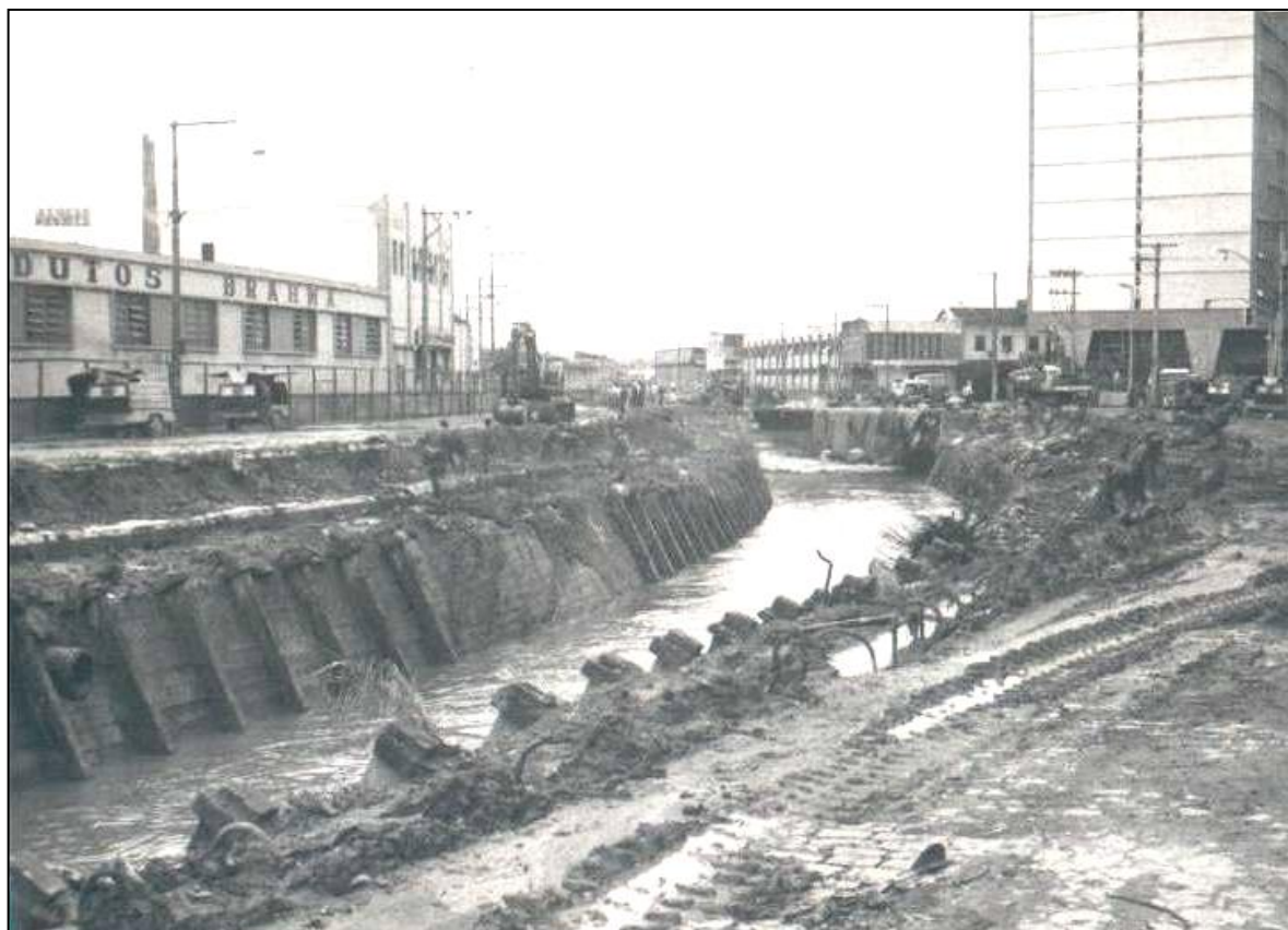
Figura 37: Rebaixamento e alargamento do Arrudas em 1982. Fonte: desconhecida. In: BORSAGLI, A. Qualquer semelhança não é mera coincidência: o destino dos rios urbanos que atravessam Belo Horizonte. http://curraldelrei.blogspot.com.br/2010/11/qualquer-semelhanca-nao-e-mera.html
