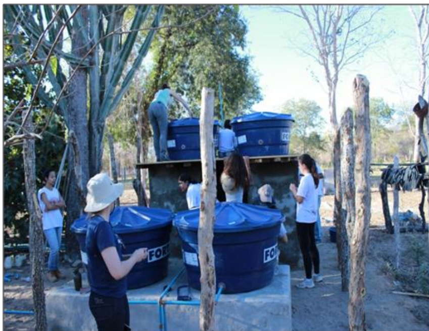
Figura 39 - Estação de tratamento de água piloto construída na casa de D. Lúcia e Sr. Anésio. Foto: Saulo F. Teixeira
