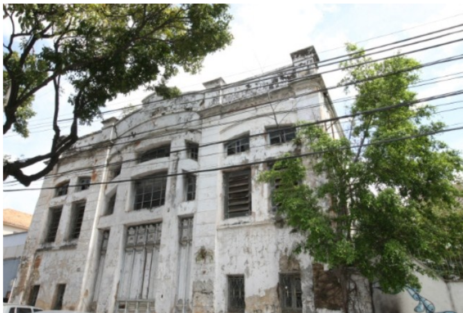
Figura 13 O abandono do casarão da Rua Manaus- 2012
