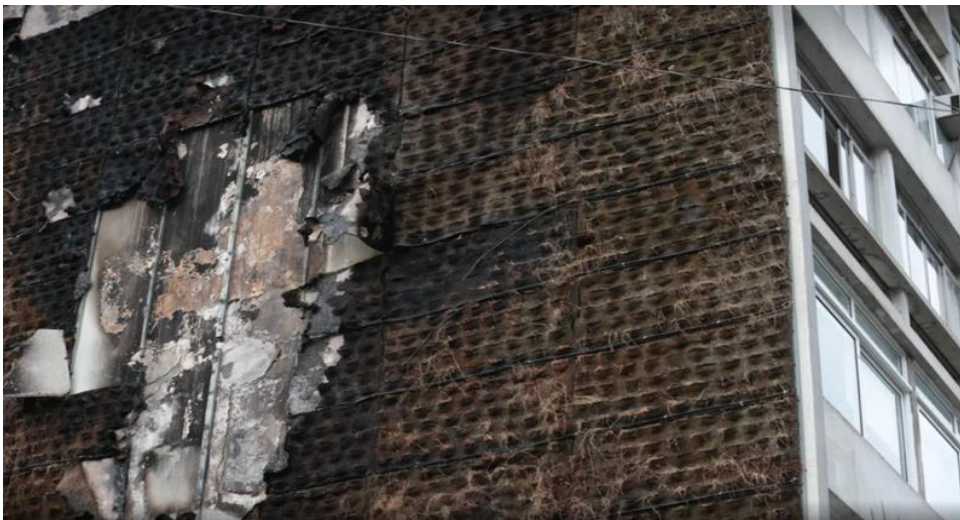
Figura 21 – Fachada vegetada do edifício Santa Cruz danificada por incêndio.
