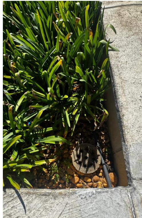
Figura 40 – Sistema de irrigação dos jardins da cobertura vegetada do Restaurante Setorial II da UFMG.
