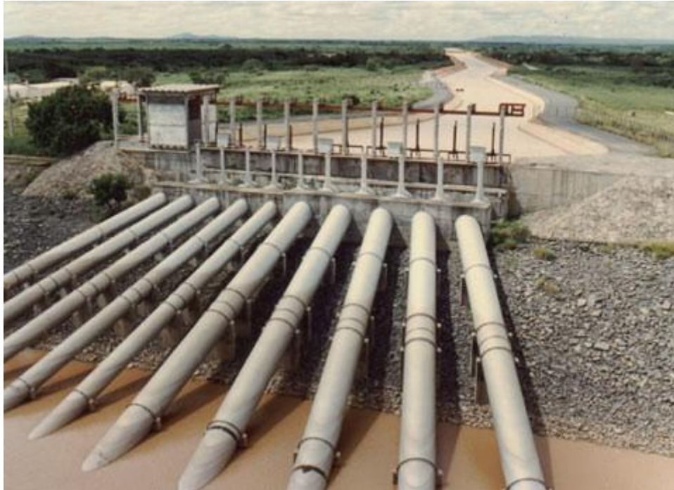
Figura 20 - Estação de bombeamento do Projeto Jaíba captando água do Rio São Francisco
