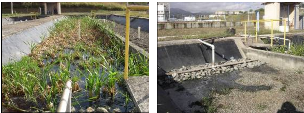
Figura 5.35: Imagens do escoamento superficial indesejado na wetland plantada, recentemente podada, e na wetland não plantada.
