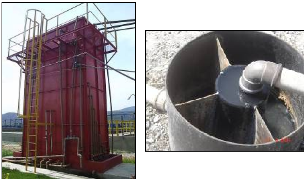
Figura 4.2: Reator UASB utilizado como pré-tratamento as wetlands e a caixa vertedora utilizada para dividir as vazões efluentes do UASB.
