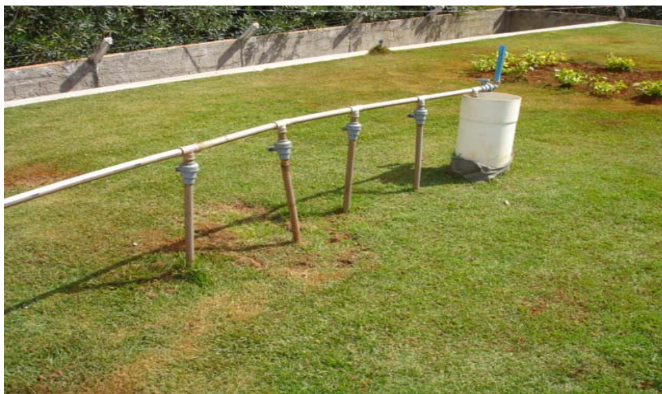
Figura 4.14 – Vista dos tubos coletores ao longo da altura do filtro
