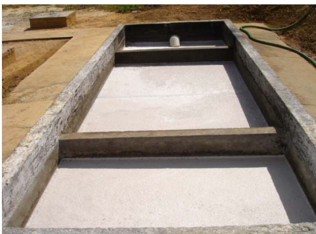
Figura 4.9 – Caixa de gordura
