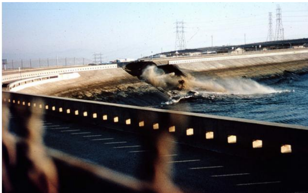
Figura 3.8 - Momento da ruptura de Baldwin Hills
