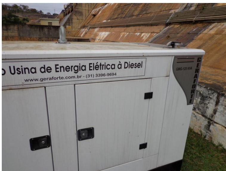
Figura 5.3 - Gerador diesel de emergência
