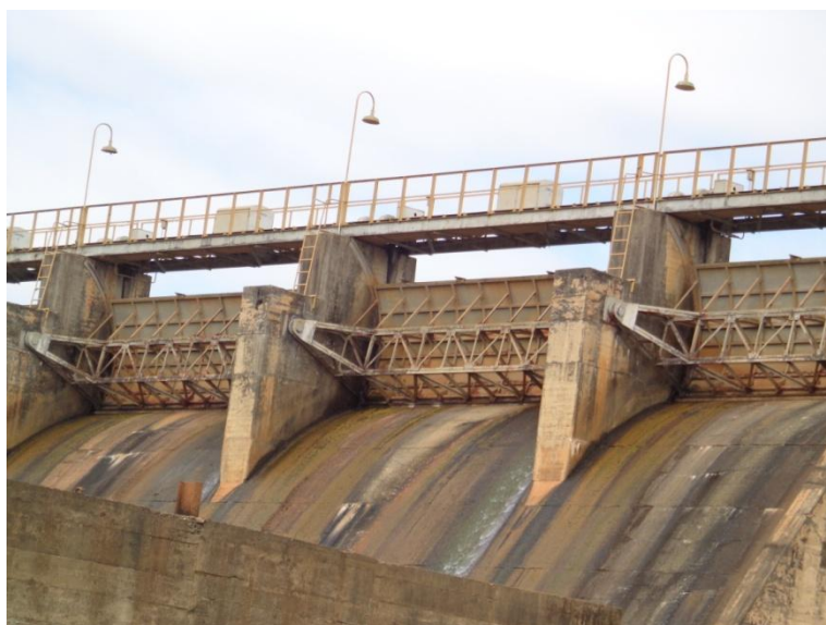
Figura 5.2 - Vertedouro e comportas da PCH de Cajuru
