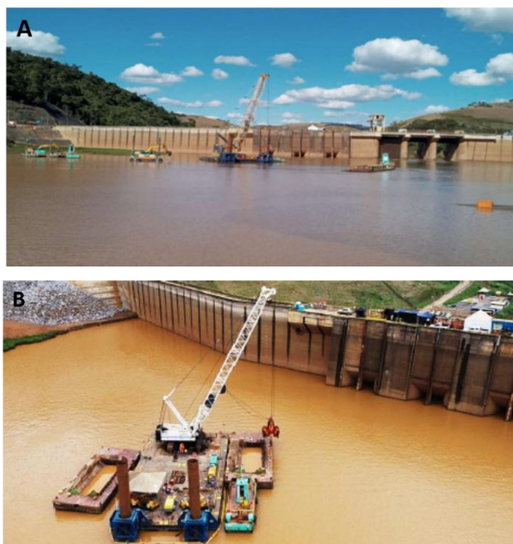
Figura 3 - A - Remoção de sedimentos dos conjuntos escavadeiras/ balsa e do conjunto guindaste/ balsa. B - Ciclo de Remoção de Sedimentos/22. Fonte: Relatório Anual de Atividades - Fundação Renova 2022/23.
