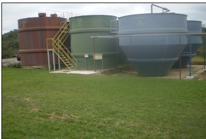
Figura 5.8 Vista parcial da ETE compacta de Catas Altas. Fonte: Autor
