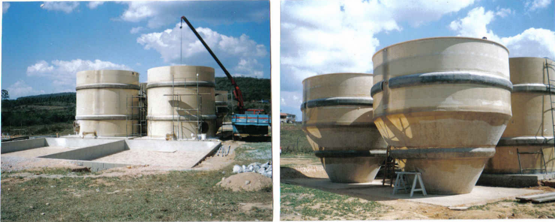
Figura 3.1 Reatores UASBs e decantadores fabricados em plástico reforçado com fibras de vidro - PRFV.
