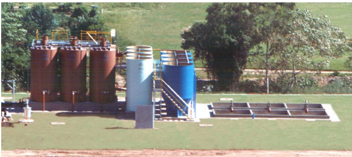
Figura 5.1 ETE compacta modelo P 3000 instalada na cidade Itajubá MG Fonte: Polyplaster, 2005
