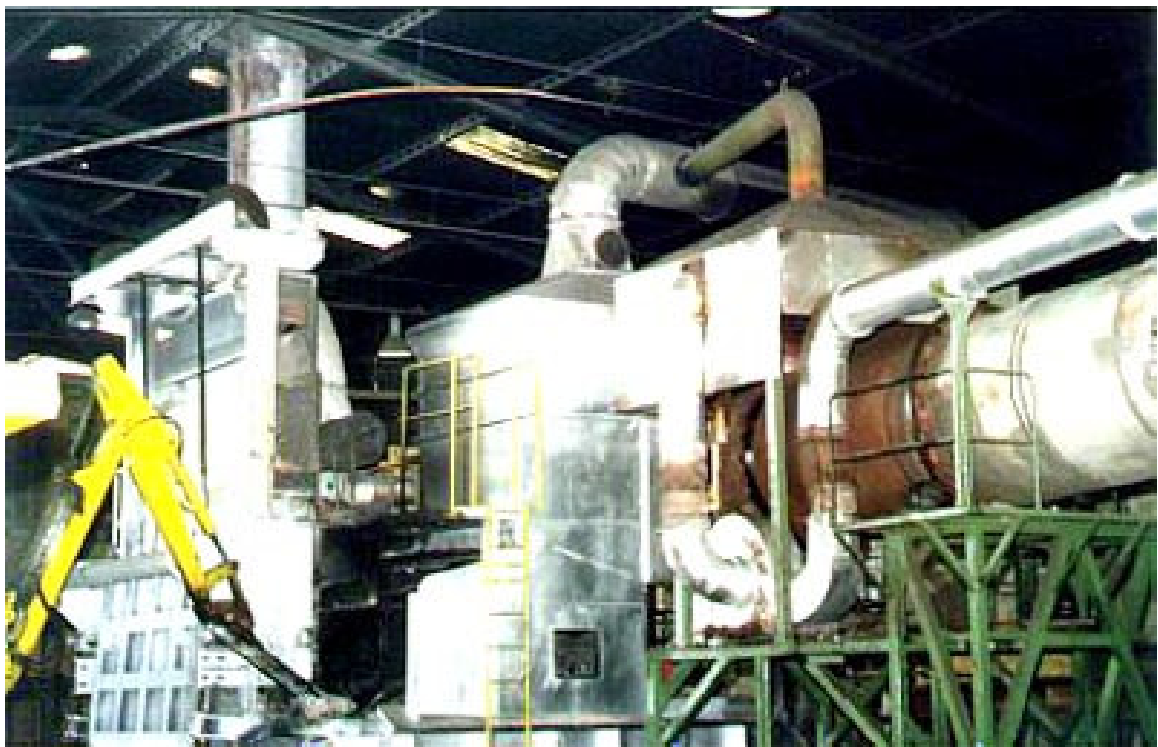
Figura 3.6 - Sistema de fundição de alumínio
