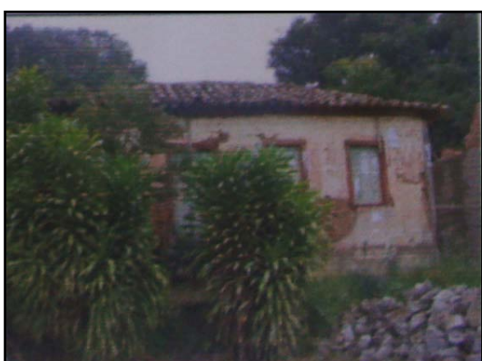
Figura 57. Imóvel com iniciais sinais de degradação em sua estrutura. Fonte: Fábio Silva – Laudo Técnico/2004.
