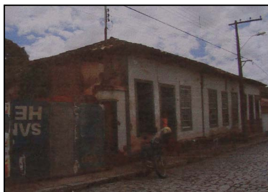
Figura 52. Imóvel abandonado. Fonte: Laudo técnico/2010. Honório Nicholls, 2010.
