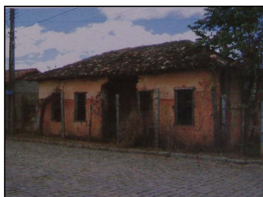
Figura 67. A mesma casa, arruinada. Fonte: Laudo técnico/2010. Honório Nicholls, 2010.
