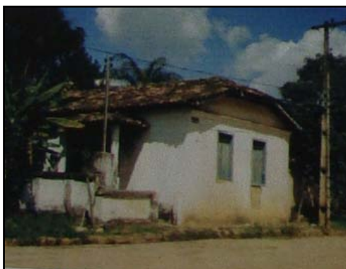
Figura 80. Imóvel no ano de 1997. Identificado como bem de interesse de preservação pelo Dossiê de Tombamento. Fonte: Laudo técnico/2000. Honório Nicholls, 2000.
