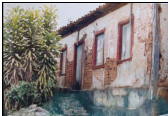
Figura 58. Imóvel com iniciais sinais de degradação em sua estrutura. Fonte: Honório Nicholls, Laudo Técnico/2006.
