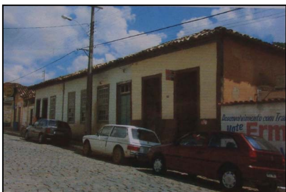
Figura 51. Imóvel com sinais de degradação em sua estrutura. Fonte: Laudo técnico/2006. Honório Nicholls, 2006.
