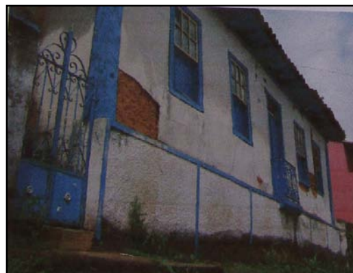
Figura 23. Em 2010, o imóvel começa a apresentar as primeiras marcas de degradação em sua estrutura. Detalhe: perda de reboco. Fonte: Laudo técnico/2010. Honório Nicholls, 2010.
