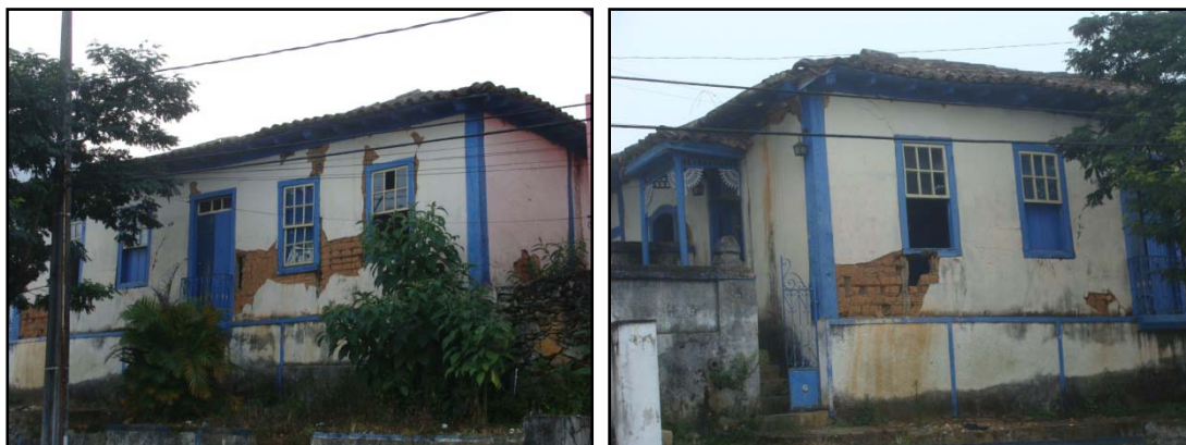
Figuras 14 e 15. Residência de tipo colonial, situada à Avenida Governador Benedito Valadares, no Núcleo Histórico Urbano de Bonfim. Imóvel com visíveis marcas de degradação em sua estrutura. Fonte: Ricardo Ferreira, 2012.
