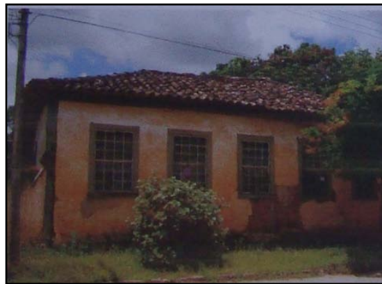
Figura 34. Em 2006 o imóvel já apresenta sinais de degradação em sua estrutura. Sujidades e perda de reboco. Fonte: Honório Nicholls, 2006.
