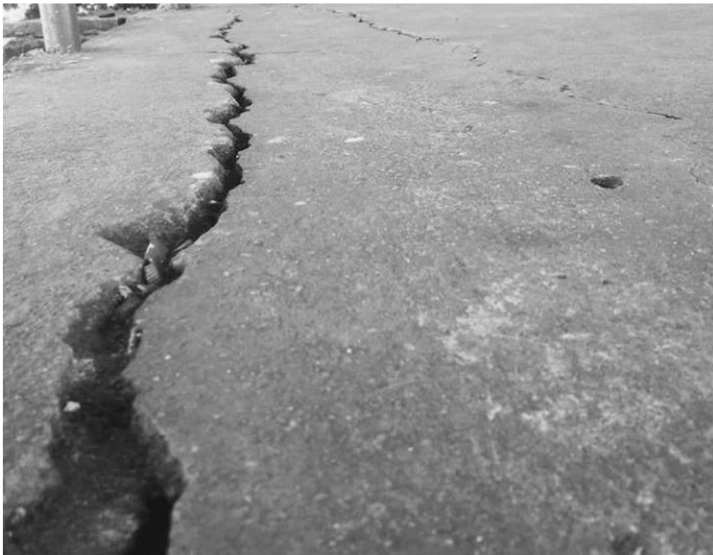
Figura 30: P.H.L., 14 anos – Rachadura – junho 2019
