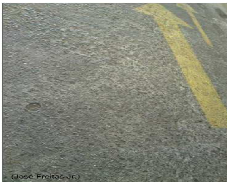
Figura 2.6: Desgaste por abrasão em pavimento de estacionamento de supermercado. Fonte: http://www.dcc.ufpr.br/wiki/images/0/01/TC031_Durabilidade.pdf (acesso em 30/12/2011).
