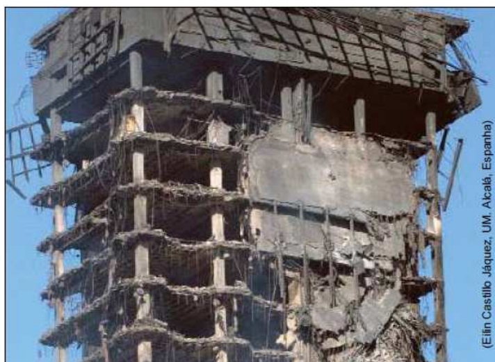
Figura 2.19: Ação destruidora do fogo em edifício de concreto armado, na Espanha. Fonte: http://www.dcc.ufpr.br/wiki/images/0/01/TC031_Durabilidade.pdf (acesso em 31/01/2012).
