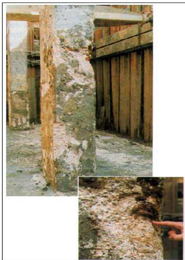
Figura 2.24: Pilar de concreto deteriorado pelo ataque de sulfatos. Fonte: COUTINHO, 2001.
