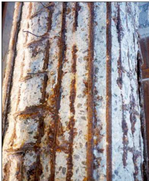
Figura 2.49: Pilar sobre o mar, após 10 anos de construção, deteriorado por carbonatação e cloretos. Fonte: AGUIAR, 2006.
