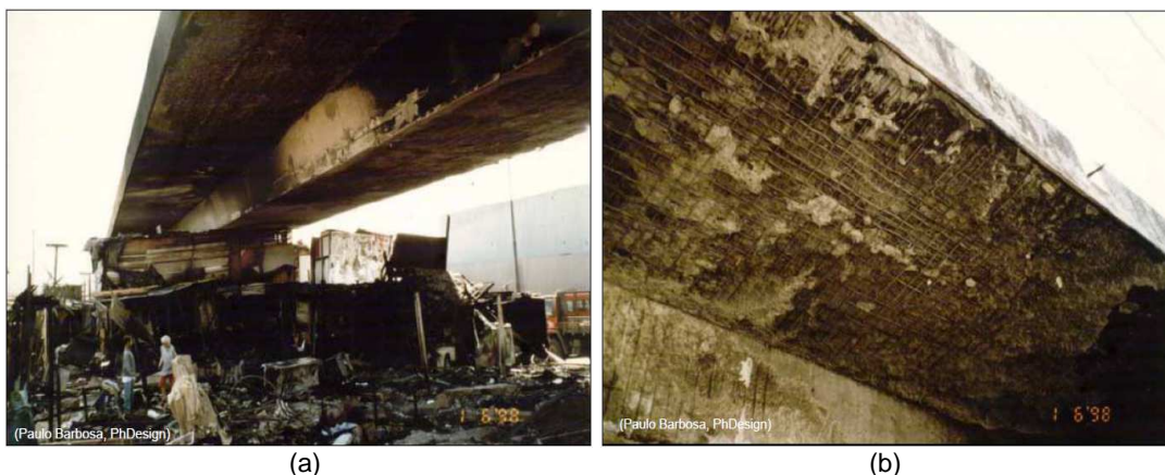
Figura 2.20: Incêndio ocorrido em viaduto em São Paulo/SP, em 1998, conforme (a) e (b). Fonte: http://www.dcc.ufpr.br/wiki/images/0/01/TC031_Durabilidade.pdf (acesso em 31/01/2012).
