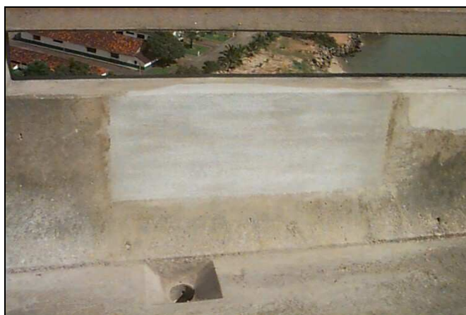
Figura 3.15: Não pode haver trincas no aspecto final da superfície recuperada. Fonte: AGUIAR, 2011.
