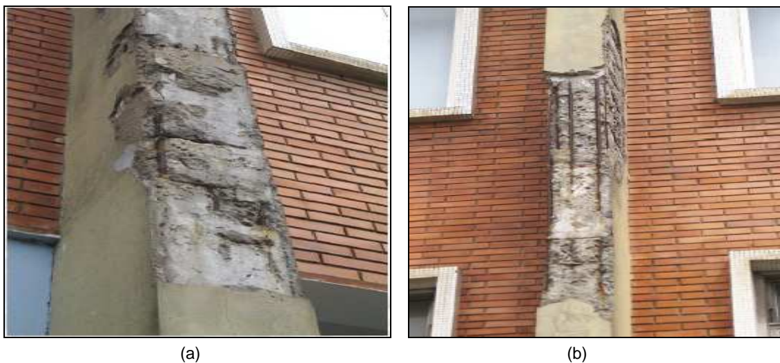
(a) (b) Figura 2.63: Corrosão em diferentes pilares (“a” e “b”) de um edifício residencial em Porto Alegre (RS). Fonte: http://www.fortium.com.br/blog/material/Corrosao.nas.Armaduras.de.concreto.armado.pdf (30.01.2012).
