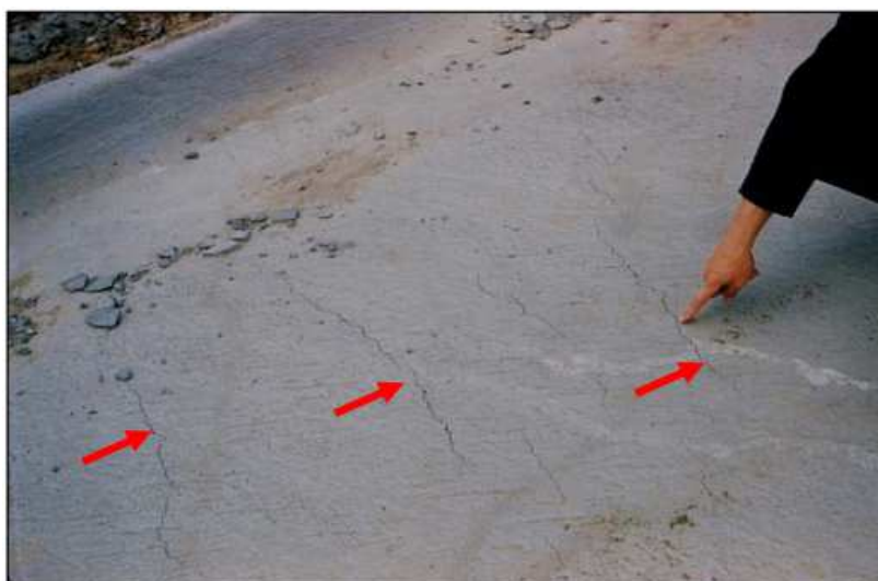
Figura 2.13: Típicas fissuras por retração plástica do concreto no estado fresco. Fonte: http://www.dcc.ufpr.br/wiki/images/0/01/TC031_Durabilidade.pdf (acesso em 31/01/2012).
