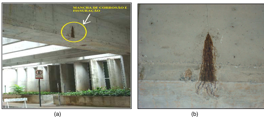
(a) (b) Figura 2.64: Mancha de corrosão e fissuração em viga de concreto armado, em (a) e (b).
