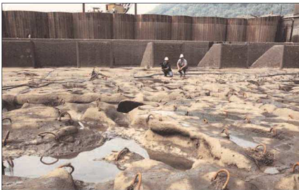
Figura 2.11: Efeitos da implosão das bolhas de cavitação em bacia de dissipação. Fonte: http://www.dcc.ufpr.br/wiki/images/0/01/TC031_Durabilidade.pdf (acesso em 30/12/2011).
