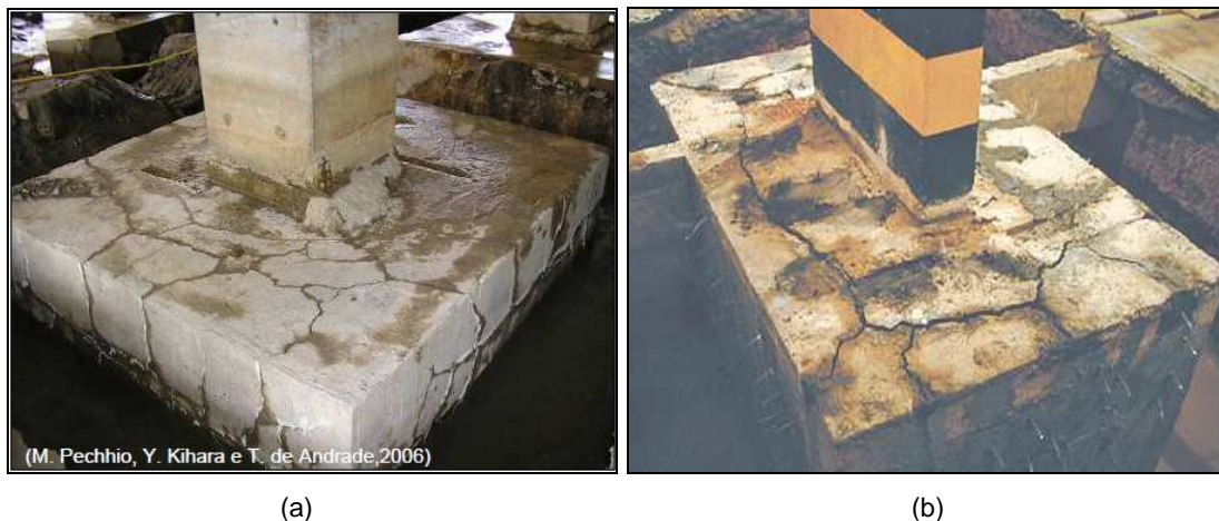
Figura 2.22: Reação álcali-agregado em blocos de fundação de edifícios em Recife-PE, conforme (a) e (b). Fonte: http://www.dcc.ufpr.br/wiki/images/0/01/TC031_Durabilidade.pdf (acesso em 31/12/2011).
