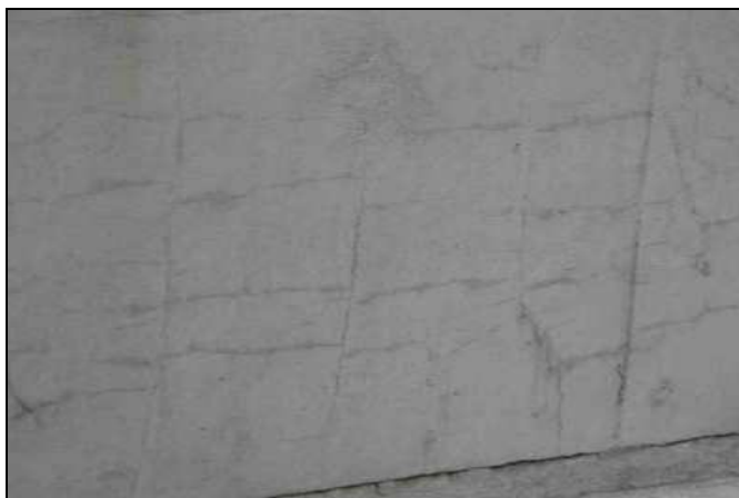
Figura 3.16: Ocorrência de retração na argamassa de reparo. Fonte: Aguiar (2011).
