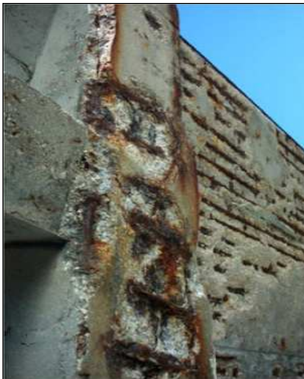
Figura 2.48: Corrosão das armaduras de concreto armado por ataque de cloretos Fonte: http://www.dcc.ufpr.br/wiki/images/0/01/TC031_Durabilidade.pdf (acesso em 21/01/2012).
