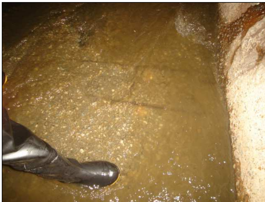
Figura 2.7: Desgaste superficial por erosão em galeria pluvial em Belo Horizonte (MG). Fonte: AGUIAR (2011).
