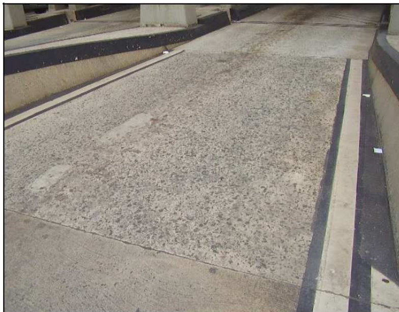
Figura 2.5: Desgaste superficial por abrasão em pavimento de concreto. Fonte: AGUIAR (2006).
